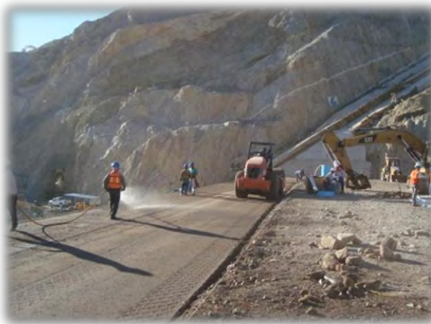
Figura 3.7 Compactaci6n con rodillo liso vibratorio del Material 2 de la cortina de ECC del P.H. La Yesca. La Figura 3.6 muestra la posici6n de este material en la cortina.
