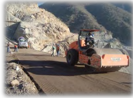
Figura 3.12 Equipo de compactación, rodillo RLV de 14 KN de peso estático en el tambor.
