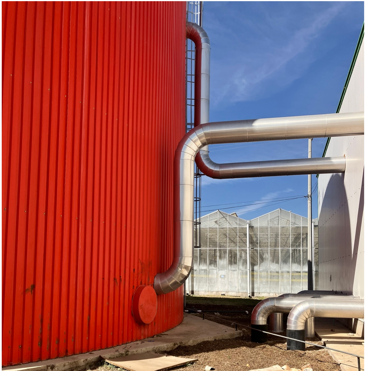
Fotografía 10. Tanque de almacenamiento de agua, Agropark
