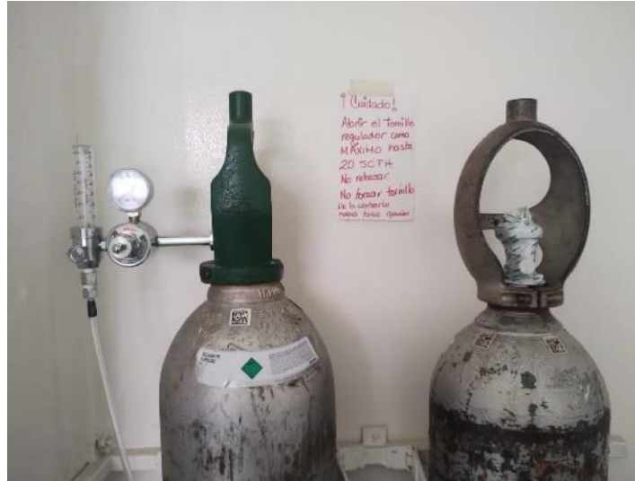
Figura XXIII. Tanques de CO 2 para cámara de eutanasia.
