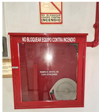
Fuente: Elaboración propia. (2023) Fig. 3.20 Gabinetes y Mangueras
