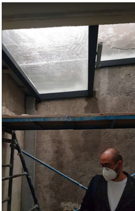
IMAGEN 014. CONTROL DE LLUVIAS EN PÉRGOLA. CASA AJUSCO. HOPELCHÉN 254. AUTOR: MANUEL CAMARILLO L JULIO -2020
