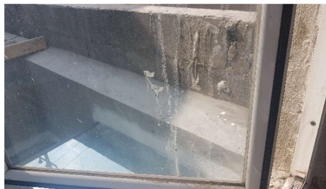
IMAGEN 008. CHAFLÁN DE CONCRETO EN MURO DE COLINDANCIA CASA AJUSCO. HOPELCHÉN 254 AUTOR: MANUEL CAMARILLO L JULIO -2020
