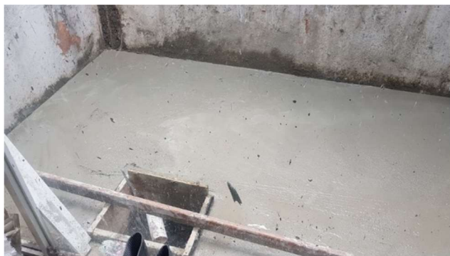
IMAGEN 009. CONCRETO VACIADO EN EXPANSIÓN DEL PRIMER NIVEL. CASA AJUSCO. HOPELCHÉN 254 AUTOR: MANUEL CAMARILLO L JULIO -2020
