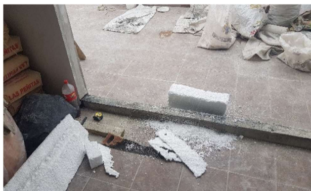
IMAGEN 010. CONSTRUCCIÓN DE SARDINEL EN HABITACIÓN DE 3er. NIVEL. CASA AJUSCO. HOPELCHÉN 254 AUTOR: MANUEL CAMARILLO L. / JULIO -2020
