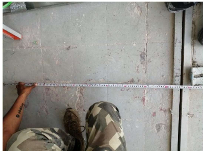
IMAGEN 034 LOSA DE CONCRETO ARMADO ORIGINAL. FARMACIA ADEXIA. AUTOR: MANUEL CAMARILLO L. ENERO -2021
