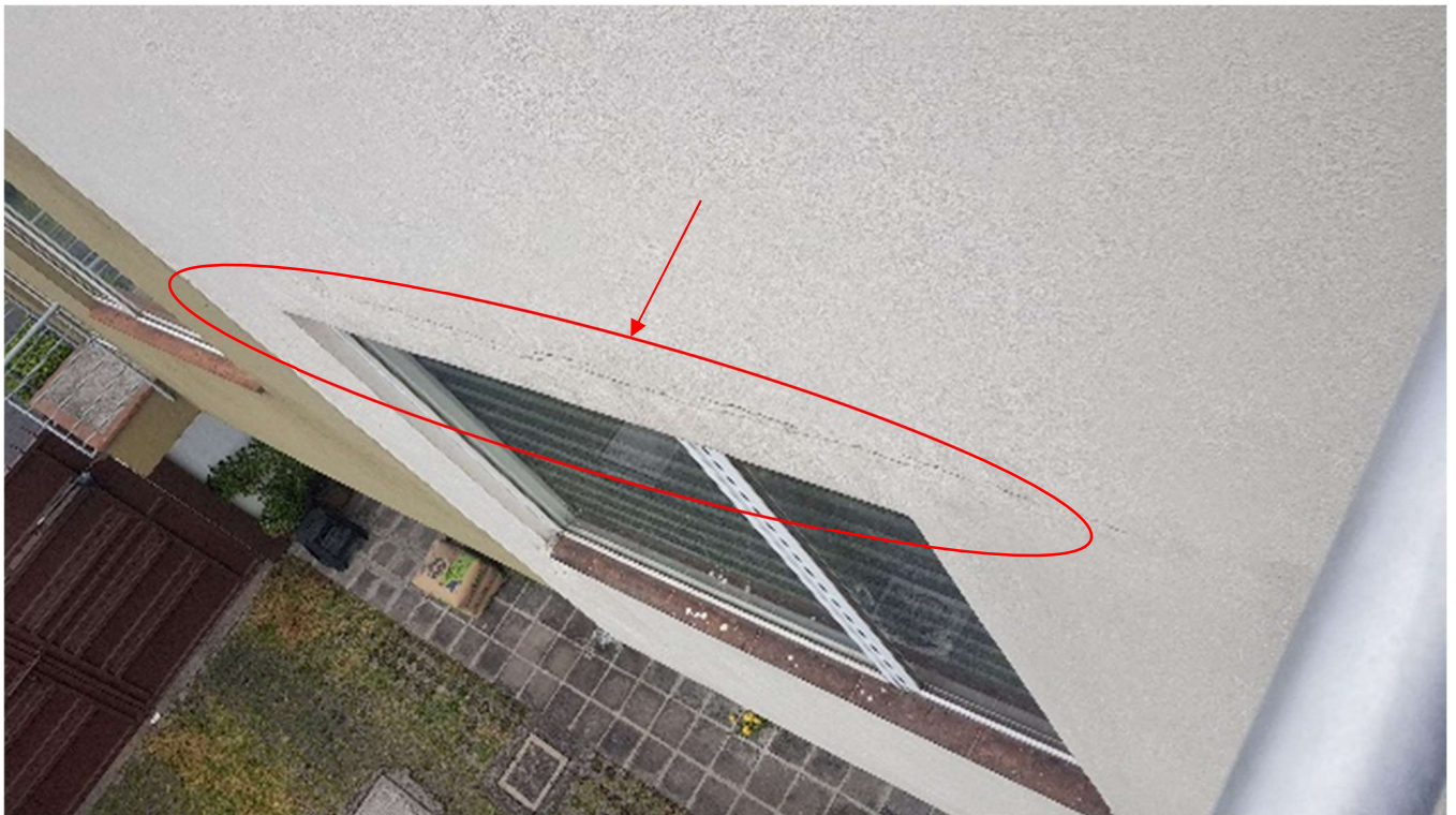
IMAGEN 016. FACHADA CON GRIETA APARENTE. CASA AJUSCO. HOPELCHÉN 254. AUTOR: MANUEL CAMARILLO L. JULIO -2020
