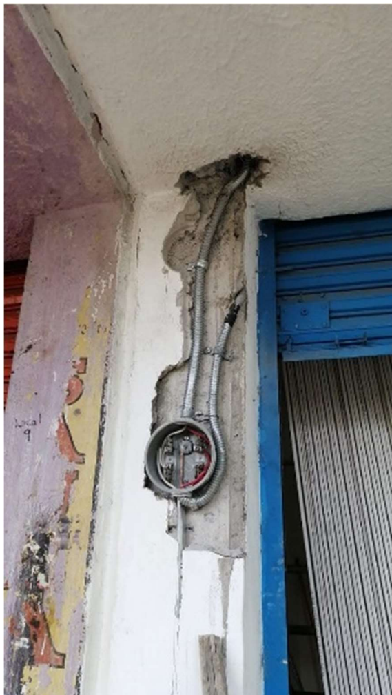
IMAGEN 040 INSTALACIÓN DE LUZ ELÉCTRICA CFE SIN MEDIDOR. FARMACIA ADEXIA. AUTOR: MANUEL CAMARILLO L ENERO -2021
