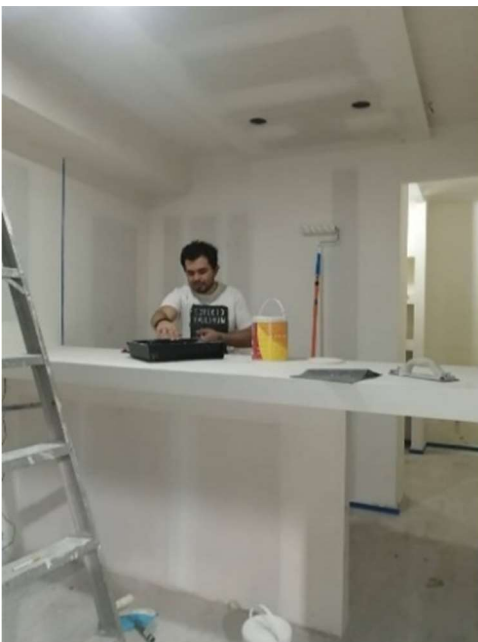
IMAGEN 036 MUROS, FALSO PLAFÓN Y RECEPCIÓN DE TABLA-ROCA. FARMACIA ADEXIA. AUTOR: MANUEL CAMARILLO L ENERO -2021
