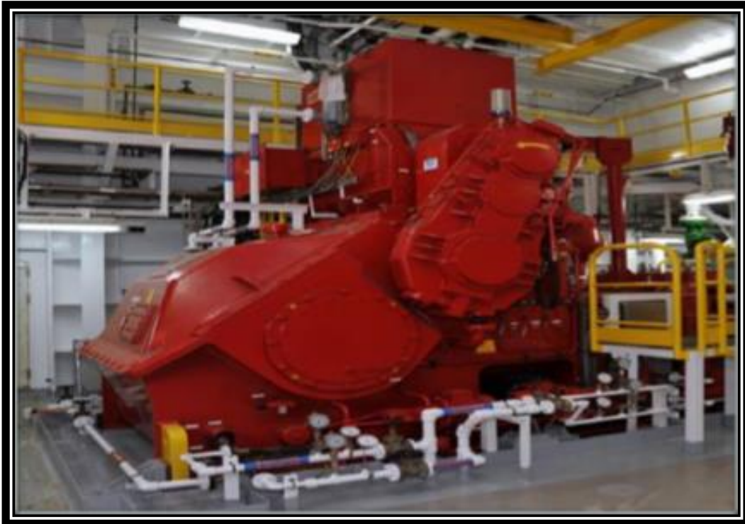
Figura 26 Bomba de lodos. (PEMEX, 2016)
