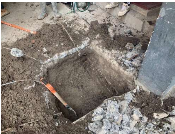
Imagen 23. Cimentación sin capas de compactación. FUENTE: Imagen propia.
