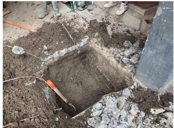
Imagen 22. Cimentación sin impermeabilización. FUENTE: Imagen propia.
