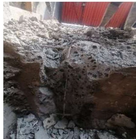
Imagen 24. Ranuras en elementos de estructurales de cimentación. FUENTE: PC Constructores.
