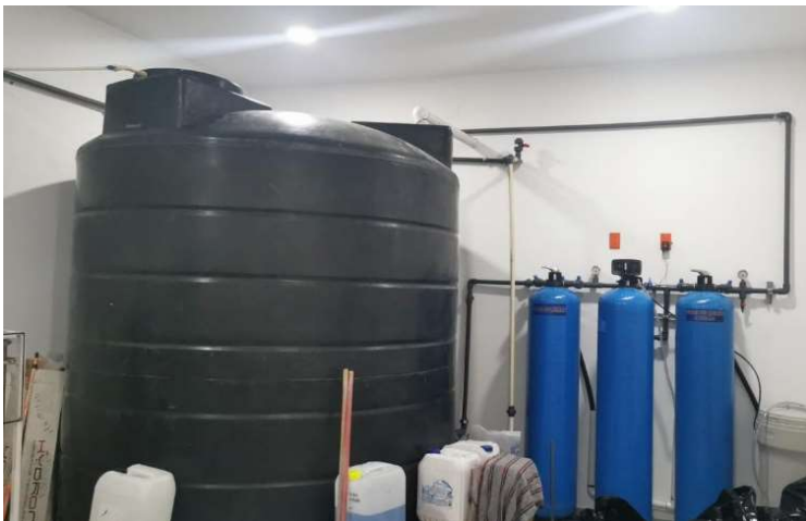
Fotografía 2. Ejemplo de área de tratamiento de agua, Clínica Hemodiálisis Integral Ermita. FUEENTE: Imagen propia.
