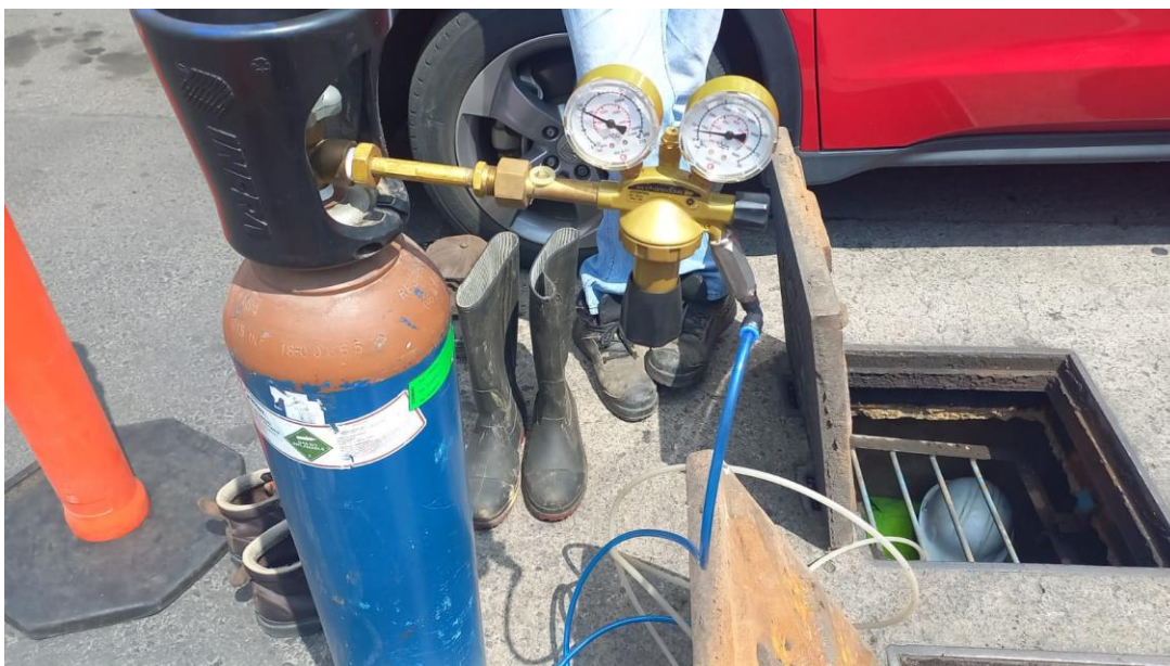
Figura 19. Mano-reductores, con manguera azul del caudalímetro. Elaboración propia.
