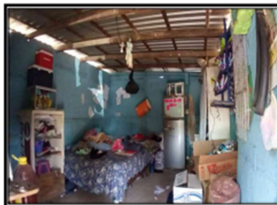
Debido al mal estado de la vivienda, las paredes de madera estan afectadas, y se encuentran manchadas y con humedad, asi como la poca pintura que se le aplico ya esta maltratada. Un dormitorio deteriorado y con goteras, que se presentan por orificios en el techo. Nos muestra las faltas que tiene su casa como las paredes con hongos, techo roto y sin espacio para cada necesidad.
