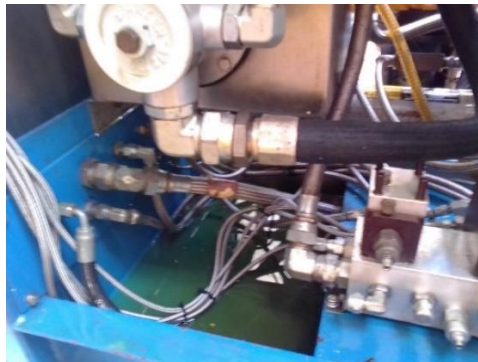
Ilustración 26. Evidencia No.1 falla en consola UPH del freno de emergencia.
