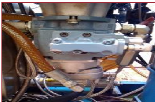
Ilustración 27. Evidencia No.2 falla en consola UPH del freno de emergencia.
