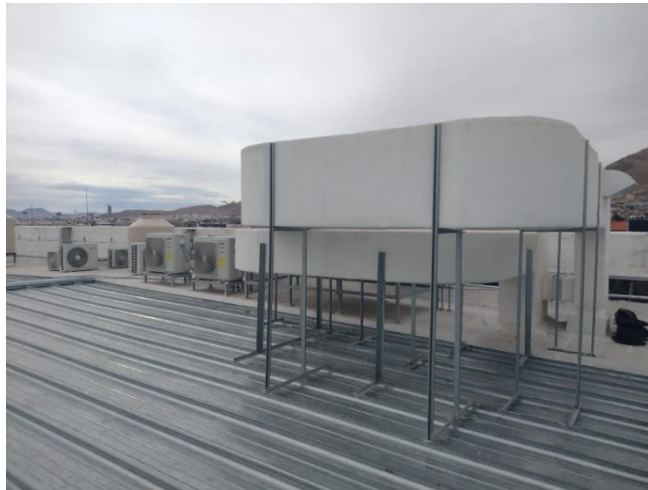
Imagen 2. Instalaciones de HVAC en azotea.
