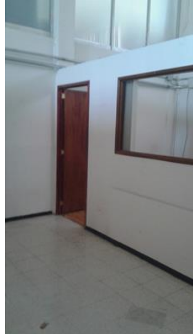
Imagen 34. Oficinas tipo del ala sur, se aprecian los espacios confinados por muros divisorios y doble altura.
