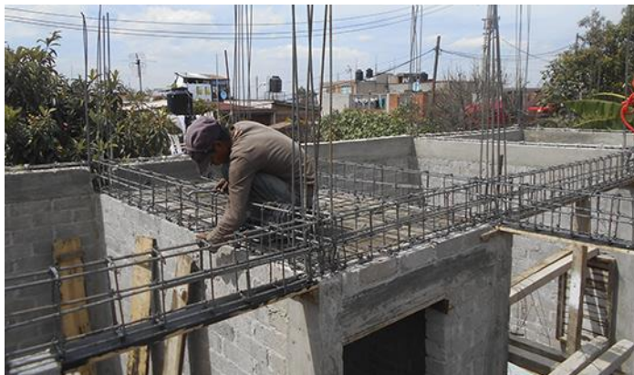
Imagen 4. Supervisión de los trabajos de albañilería para la construcción de una vivienda.
