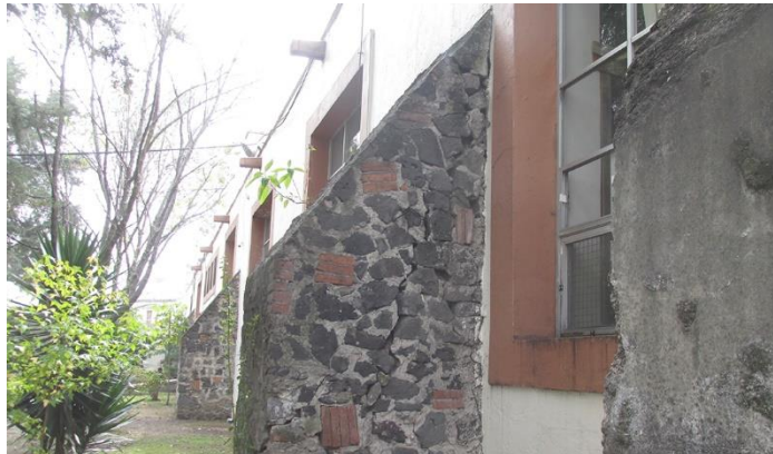
Imagen 27. Fractura de elementos estructurales, contrafuerte de mampostería de piedra.
