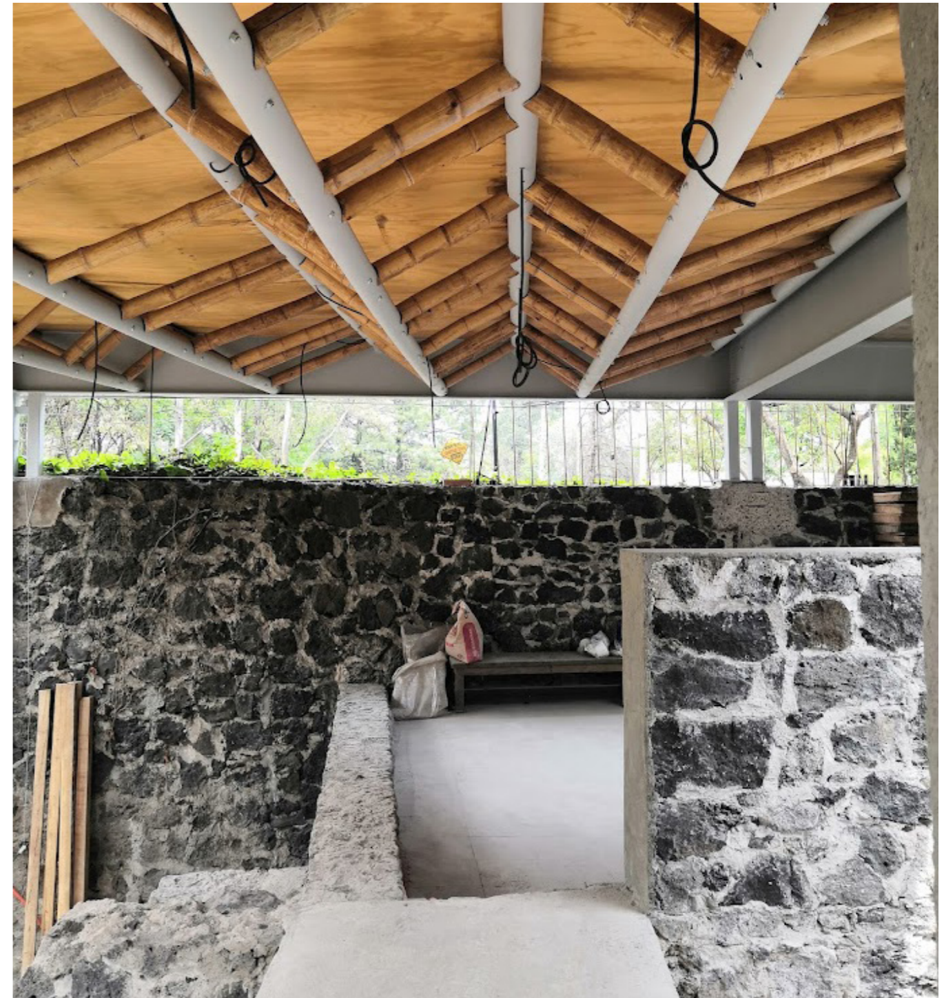
Fotografía 5 - Levantamiento Fotográfico para Análisis de Sitio, se muestra el flecheo en losa existente. Propiedad Equipo Charpente Interiorismo y Carpintería.
