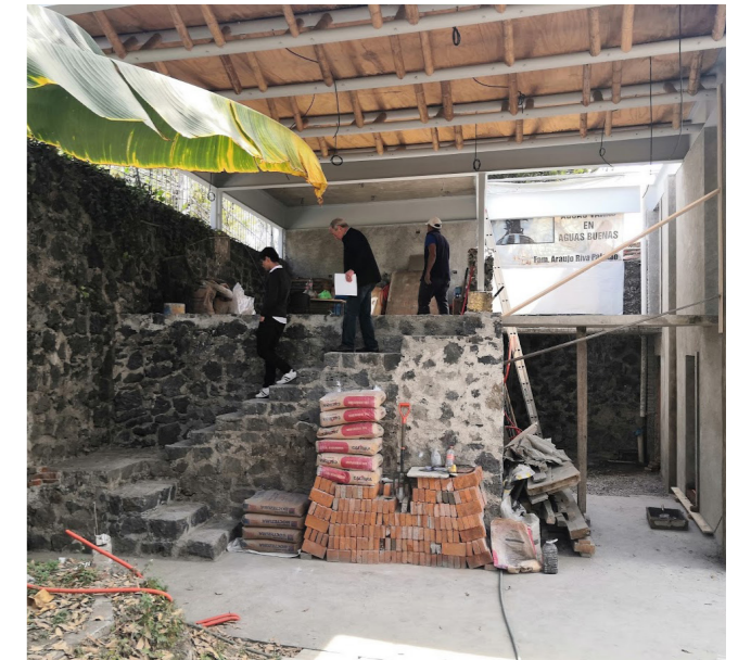
Fotografía 2 - Levantamiento Fotográfico para Análisis de Sitio Propiedad equipo Charpente Interiorismo y Carpintería
