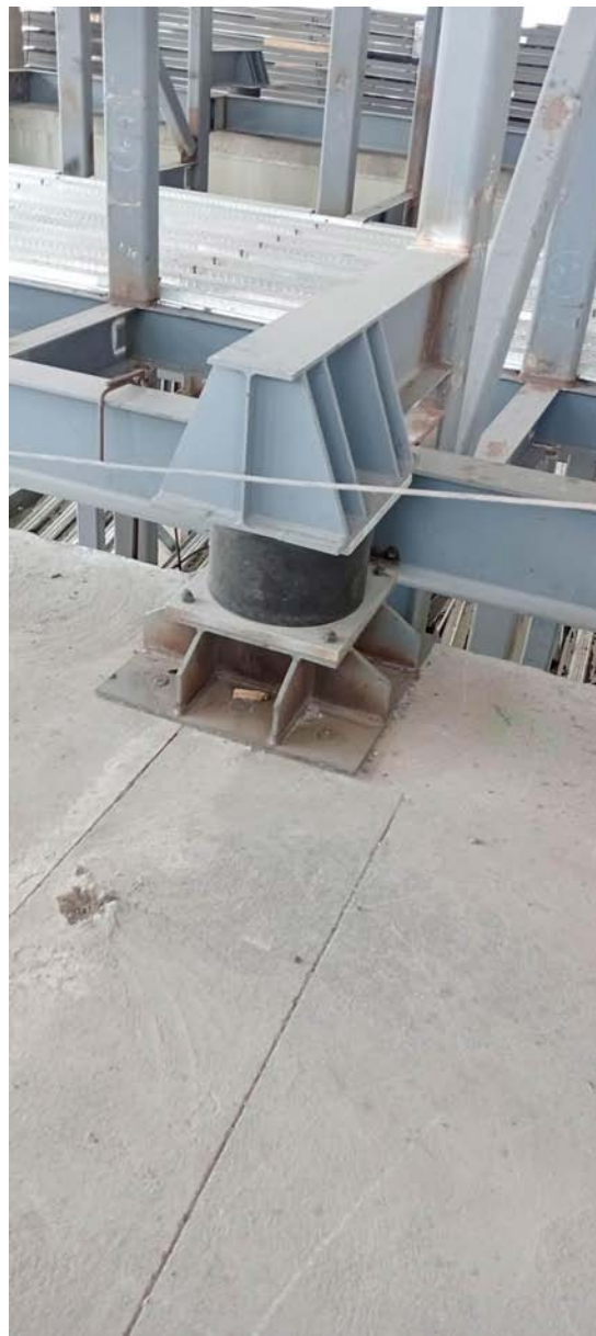
Figura 64. Aislador sísmico de un conjunto de elevadores.
