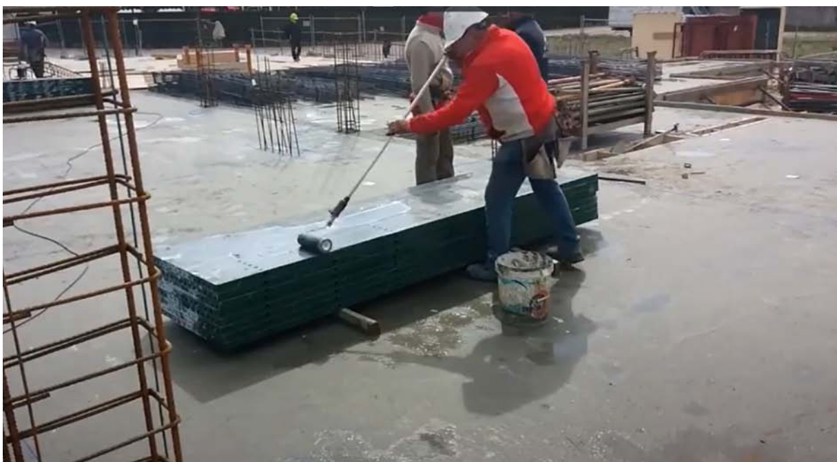
Figura 21. Impregnación de líquido desmoldante a la cimbra metálica de contacto para columna de área transversal cuadrada.
