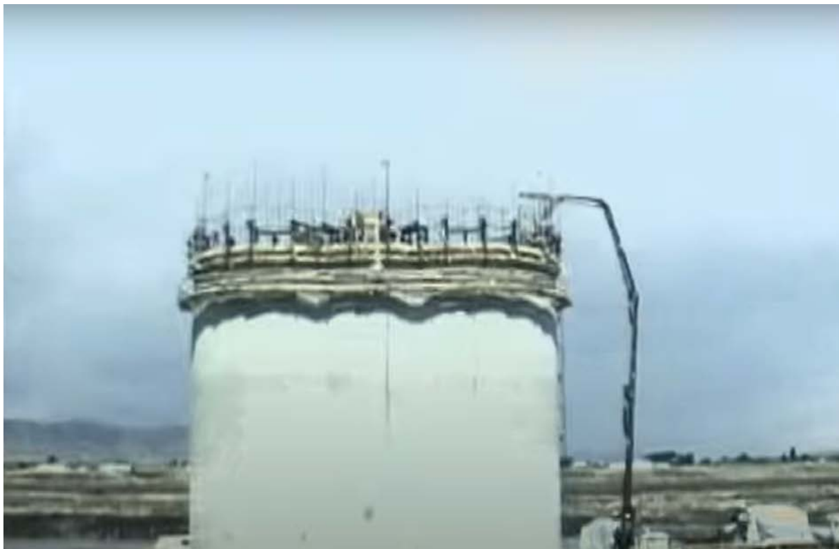
Figura 14. Cimbra deslizante en la construcción de un silo en el estado de Oregon, Estados Unidos. AVPMedia [@AVPMedia1]. (2010, Marzo 11). Slip-form construction time lapse - The Dalles, Oregon . Youtube. https://www.youtube.com/watch?v=G_6_5bZFIL0
