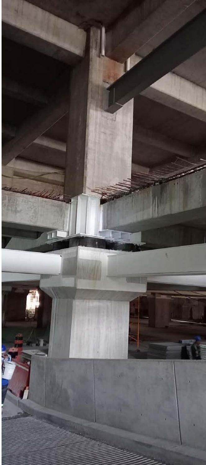
Figura 76. Columna terminada con aisladores sísmicos en su nodo.
