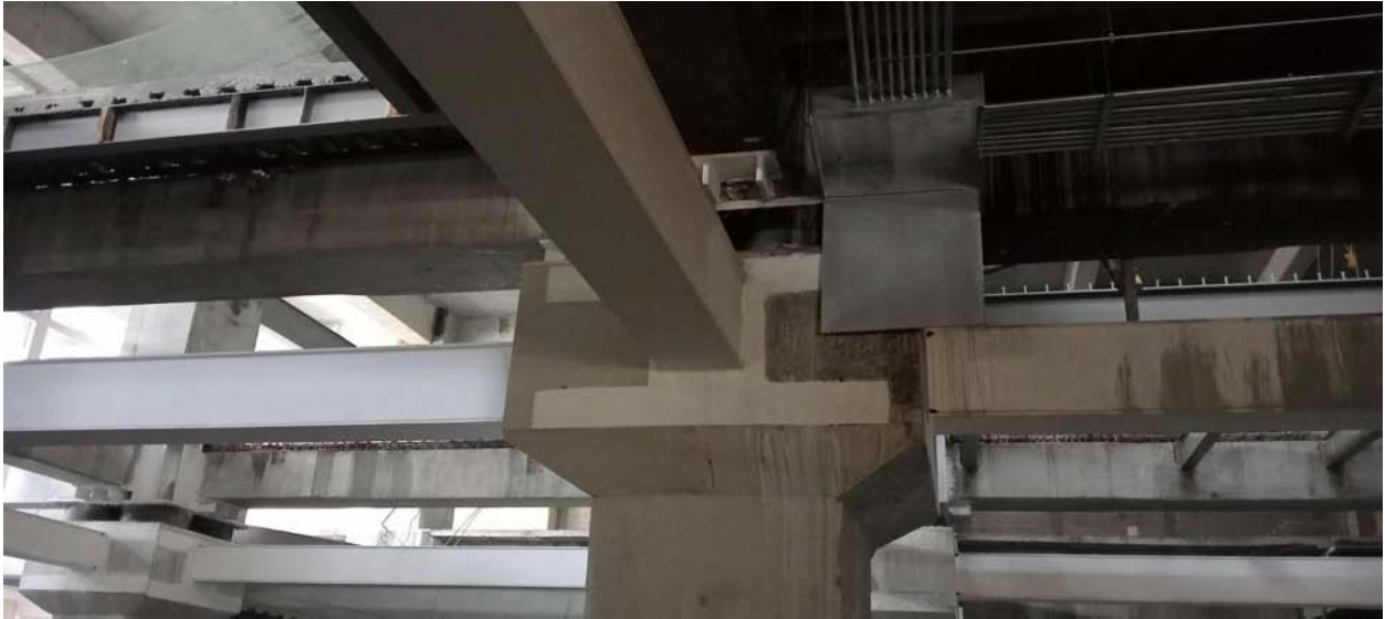
Figura 74. Unión viga-columna en nodo de entre piso entre sótano 1 y planta baja.
