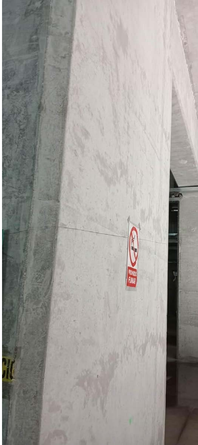
Figura 73. Columna terminada que presenta una grieta por temperatura.
