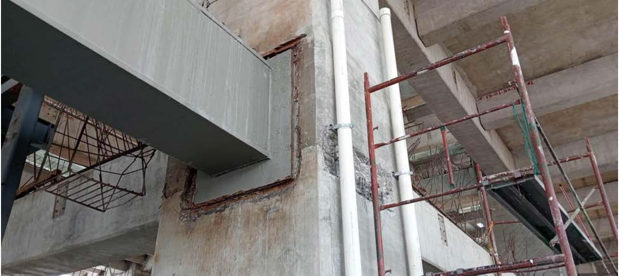
Figura 66. Union de columna-viga con corte irregular.
