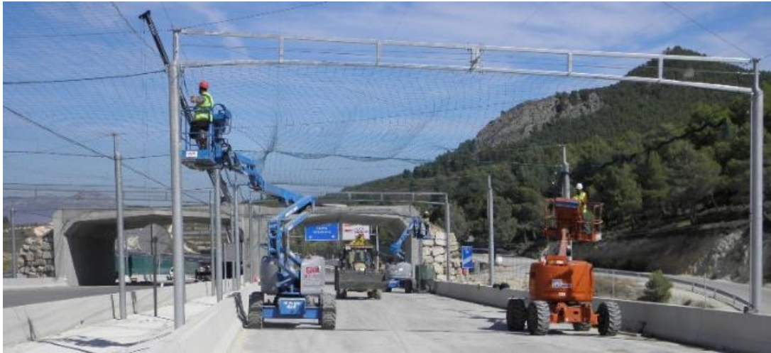
Figura 24 Colocación de malla que limita el vuelo de aves y murciélagos a ras de la corona de la infraestructura lineal
