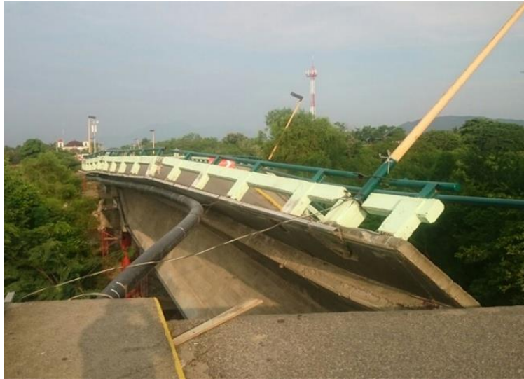
Figura 2.8 Colapso de superestructura (Twitter @PoliciaFedMx)
