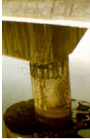
Figura 2.1 Falla en columna por pandeo del acero de refuerzo y fractura del concreto.
