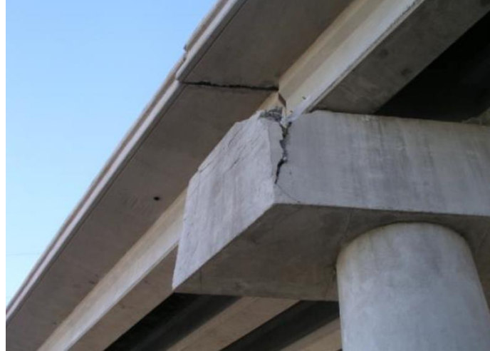
Figura 2.6 Falla en topes sísmicos (Lara, 2013)
