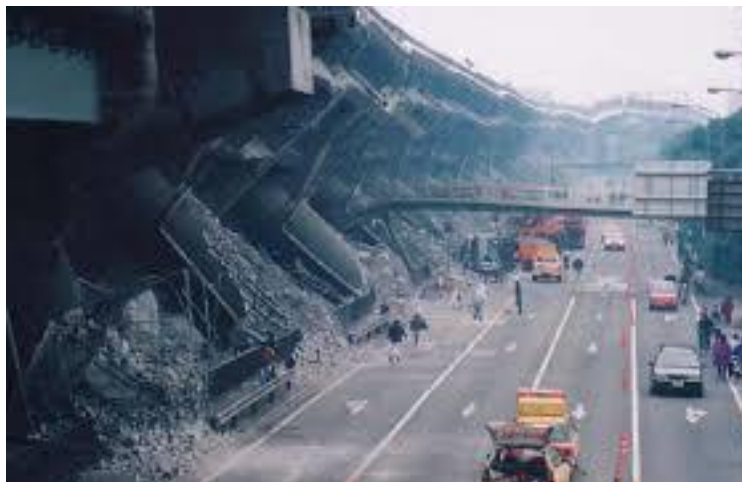
Figura 2.17 Falla por cortante en columnas.
