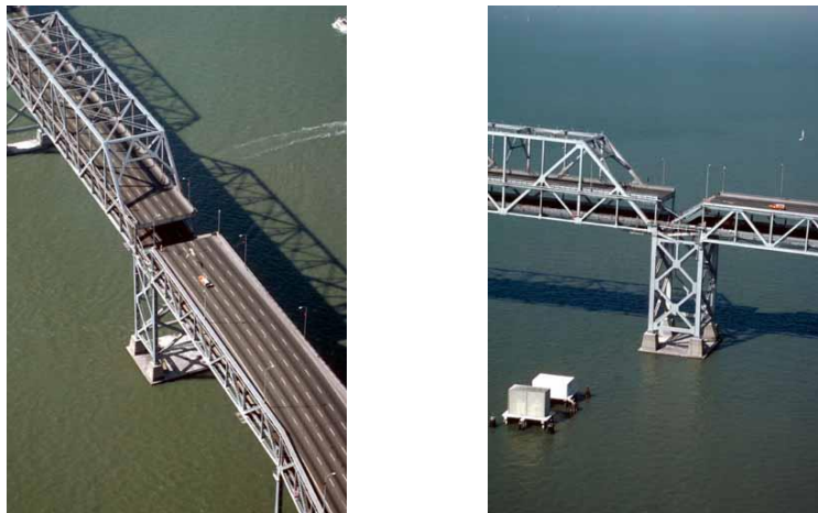
Figura 2.13 Falla en tableros superior e inferior del puente de la Bahía Oakland- San Francisco, Sismo de Loma Prieta, 1989 (Nakata, et al. , 1999)
