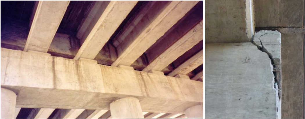
Figura 2.4 Falla en topes sísmicos y desplazamiento relativos en pilas (Alcocer et al., 2003)
