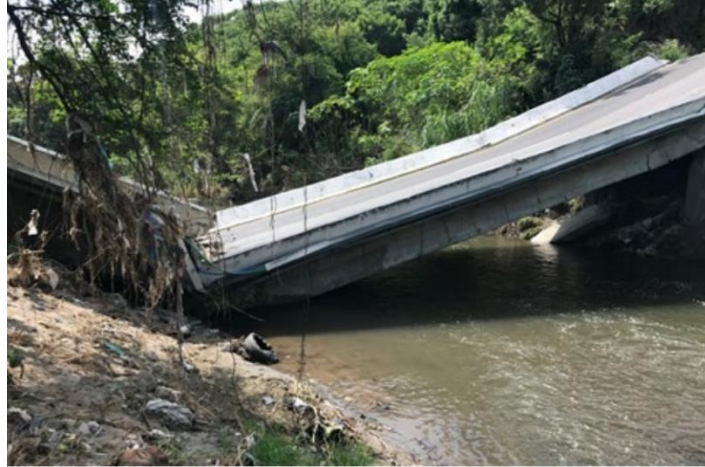
Figura 2.11 Colapso total de puente
