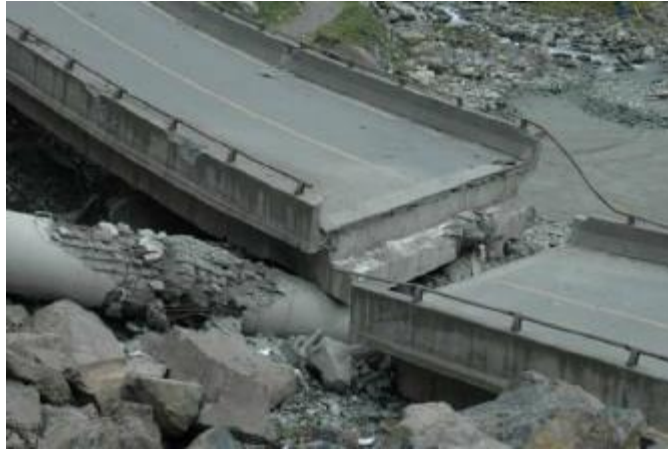
Figura 2.19 Colapso del puente Baihwa (Lin et al. , 2010).
