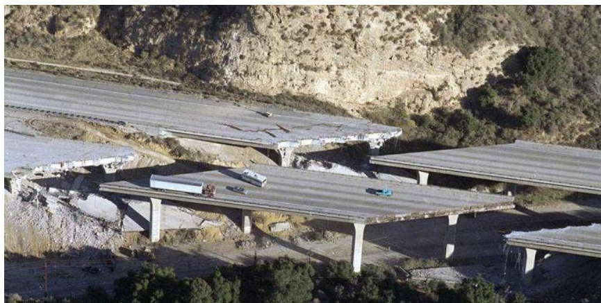
Figura 2.15 Falla por pérdida de apoyos y movimiento de traslación y rotación de estribos y diafragmas.
