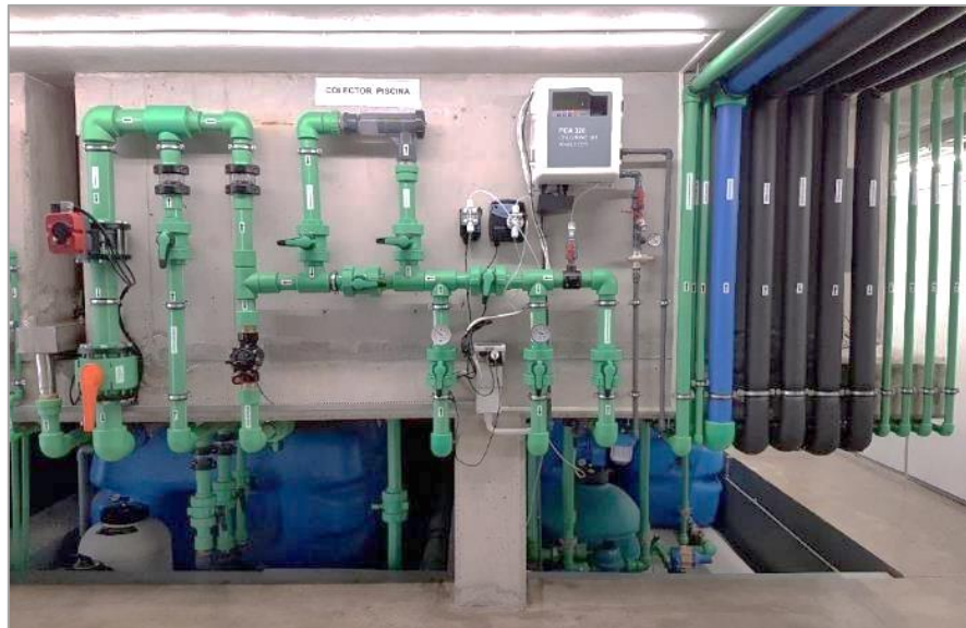
Ilustración 1. 6. Red distribución de agua potable con tubería PPR.
