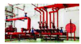
EQUIPO BOMBA CONTRA INCENDIOS
