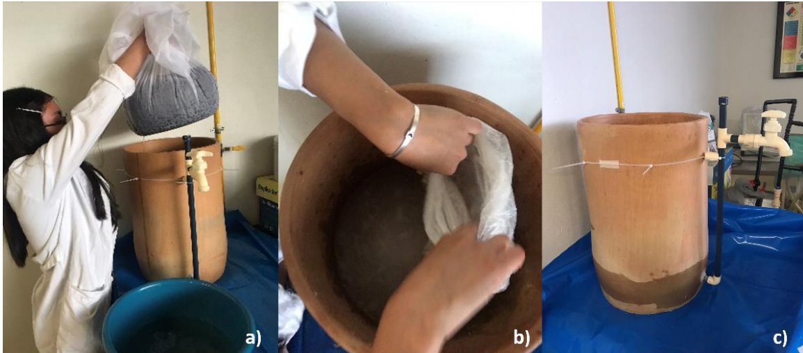
Figura 4.10 Instalación del filtro. a) Colocación de la grava con la tergalina. b) Vaciado de la marmolina. c) filtro instalado
