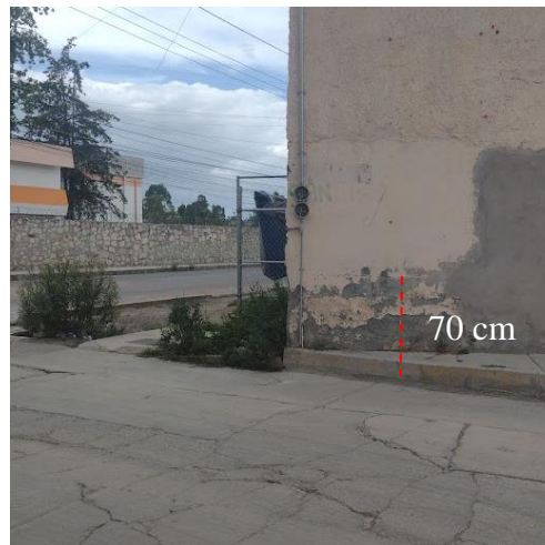
Figura 108. Fotografía con el tirante de agua acumulada, 70 cm en pared, Calle del Chopo, Colonia El Tezontle, Pachuca de Soto, Hidalgo.
