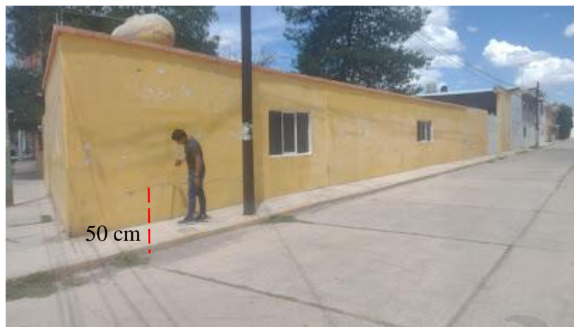
Figura 111. Fotografía con el registro del tirante de agua acumulada en pared, Calle Ócalo, Colonia el Tezontle, Pachuca de Soto.
