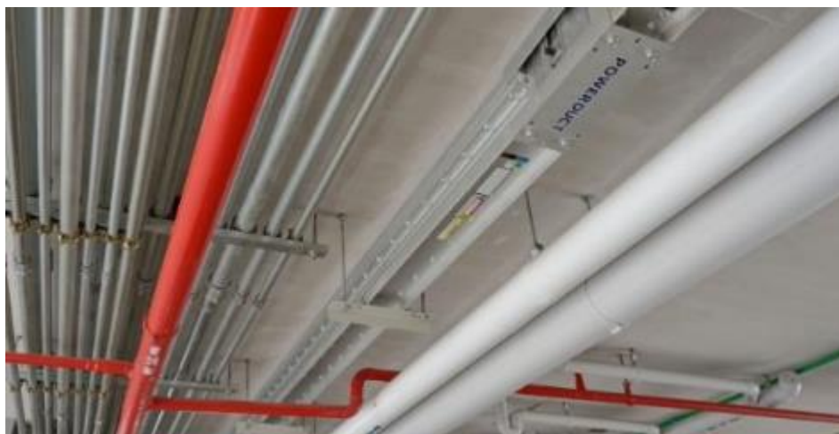
Imagen 40. Ejemplo de distintas líneas de instalaciones Fuente: Seisamed. [Instalaciones] Recuperado el 27 de junio del 2023, de seisamed.com/instalacion- electronica-de-las-redes-de-gases- medicinales
