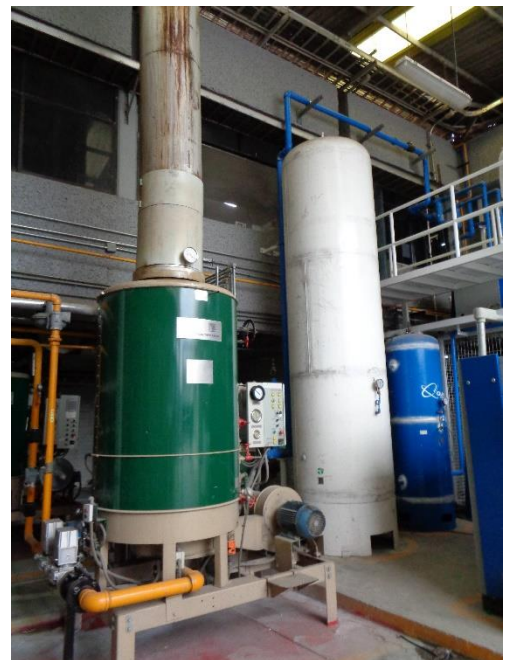
Imagen 13. Equipos existentes (calderas) con una altura superior a los 3m [Fotografía] Elaboración propia. (2022) Edo. Mex.
