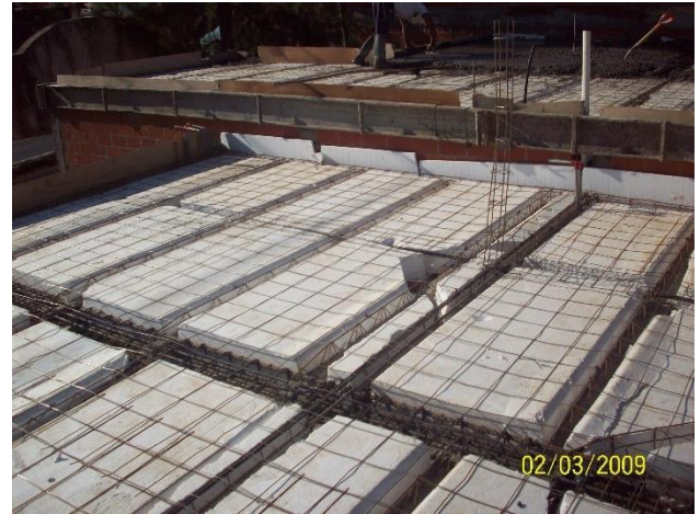
Anclaje de Armex para tinaco
