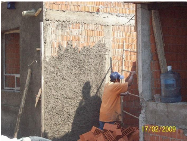
Incorrecta ejecución de aplanado
