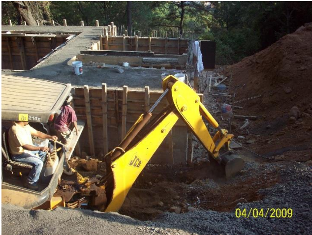
Plataforma para tanque de influente
