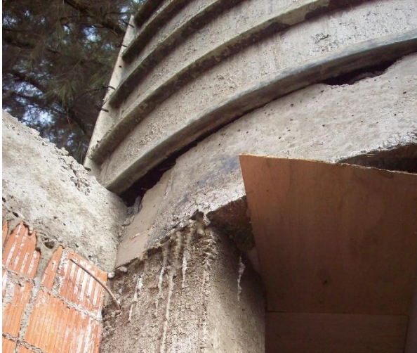
Despostilladuras en losa
