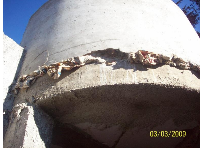
Problemas para empatar elementos
