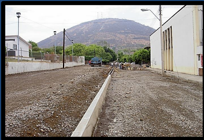
Construcción de garniciones de concreto aparente armado F'C= 200 \text{ kg/cm}^2 con una sección de 0.20 m x 0.40 m con dala armex; para banquetas y camellón
