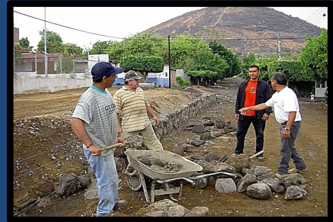
Construcción de mamposteo de piedra braza juntada con mezcla de mortero – arena en proporción 1:5, con una sección de 0.80 m de base x 0.90 m de altura y 0.30 m de corona.
