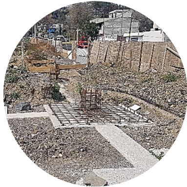
CIMENTACIÓN EXISTENTE INCONCLUSA.
