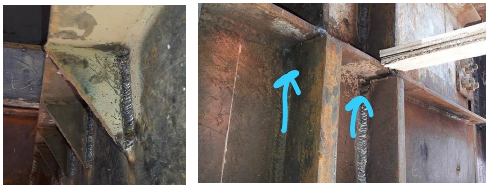
Figura 1.11 Falta de soldadura en cartabones de ménsula FUENTE: Fotos detalles indicados por Supervisión, Obra Ciudad de México
