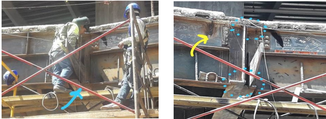
Figura 1.19 Detalle trabe En azul se marca los cortes generados de la trabe , en amarillo se señala la trabe a la que se le retiro un atieizador afuera FUENTE: Fotos detalles indicados por Supervisión, Obra Ciudad de México
