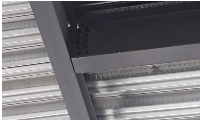
Figura 1.17 Falta de tornillería en trabe secundaria. FUENTE: Fotos detalles indicados por Supervisión, Obra Ciudad de México
