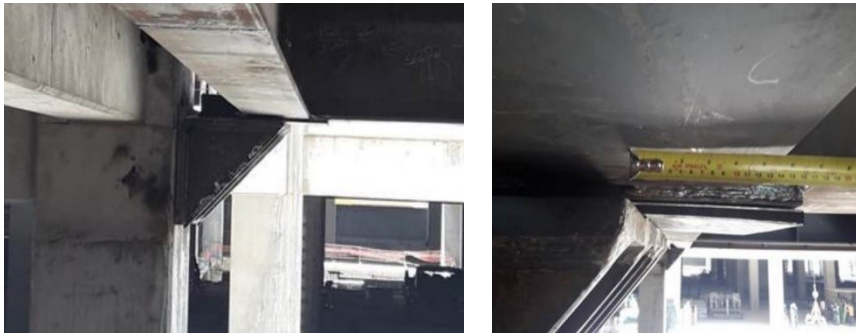
Figura 1.18 Trabe riel fuera de la ménsula , 15 cm afuera FUENTE: Fotos detalles indicados por Supervisión, Obra Ciudad de México
