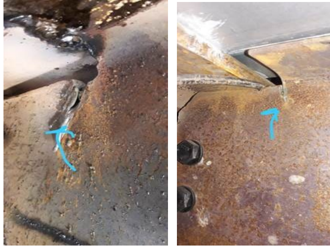
Figura 1.12 Cortes en almas de trabe debido a un mal proceso de despatinado FUENTE: Fotos detalles indicados por Supervisión, Obra Ciudad de México
