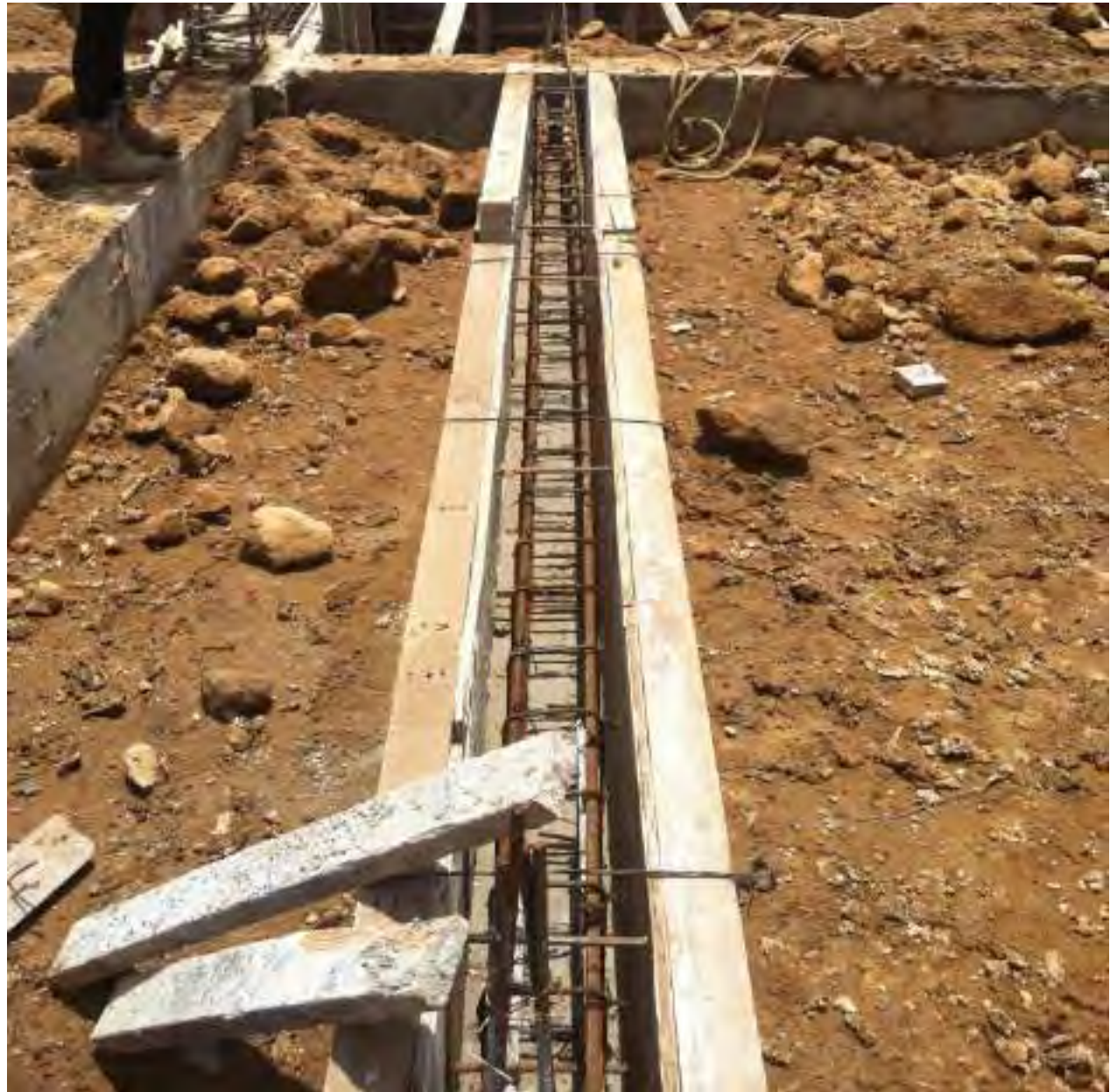
Fotografía de cimbrado y armado para colar contratabe de concreto del edificio C.
