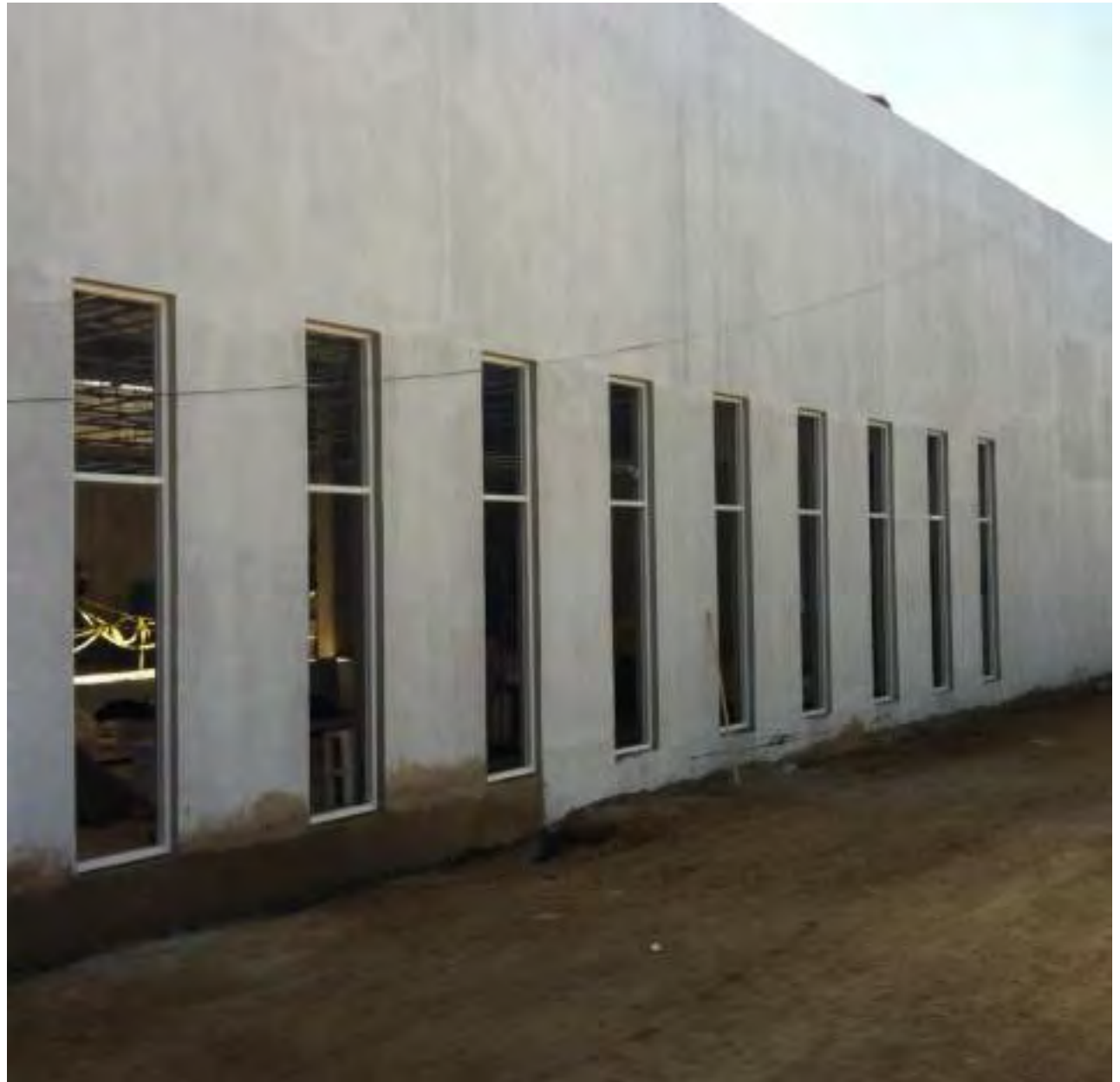
Fotografía en la que podemos apreciar el aplanado de los muros de exterior del edificio D además del emboquillado de los vanos, y la cancelaría de fachada que recibirá el cristal de las ventanas.
