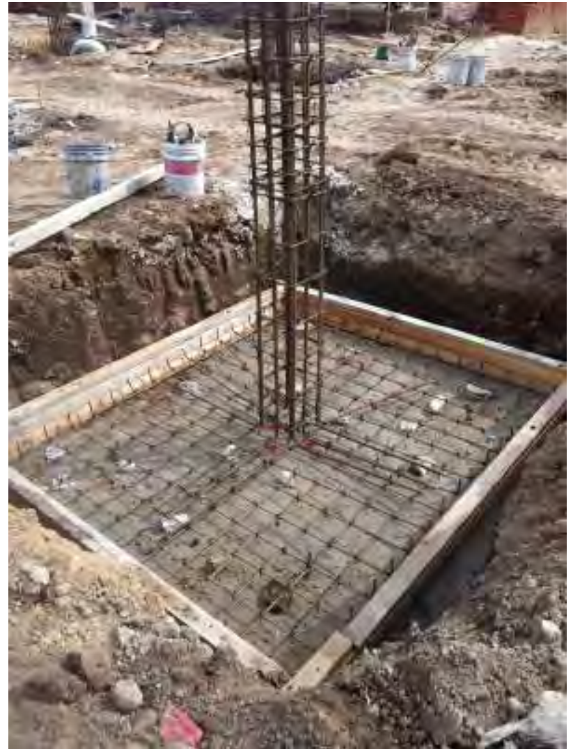
Fotografía del armado estructural de la zapata aislada Z-5 del edificio C.
