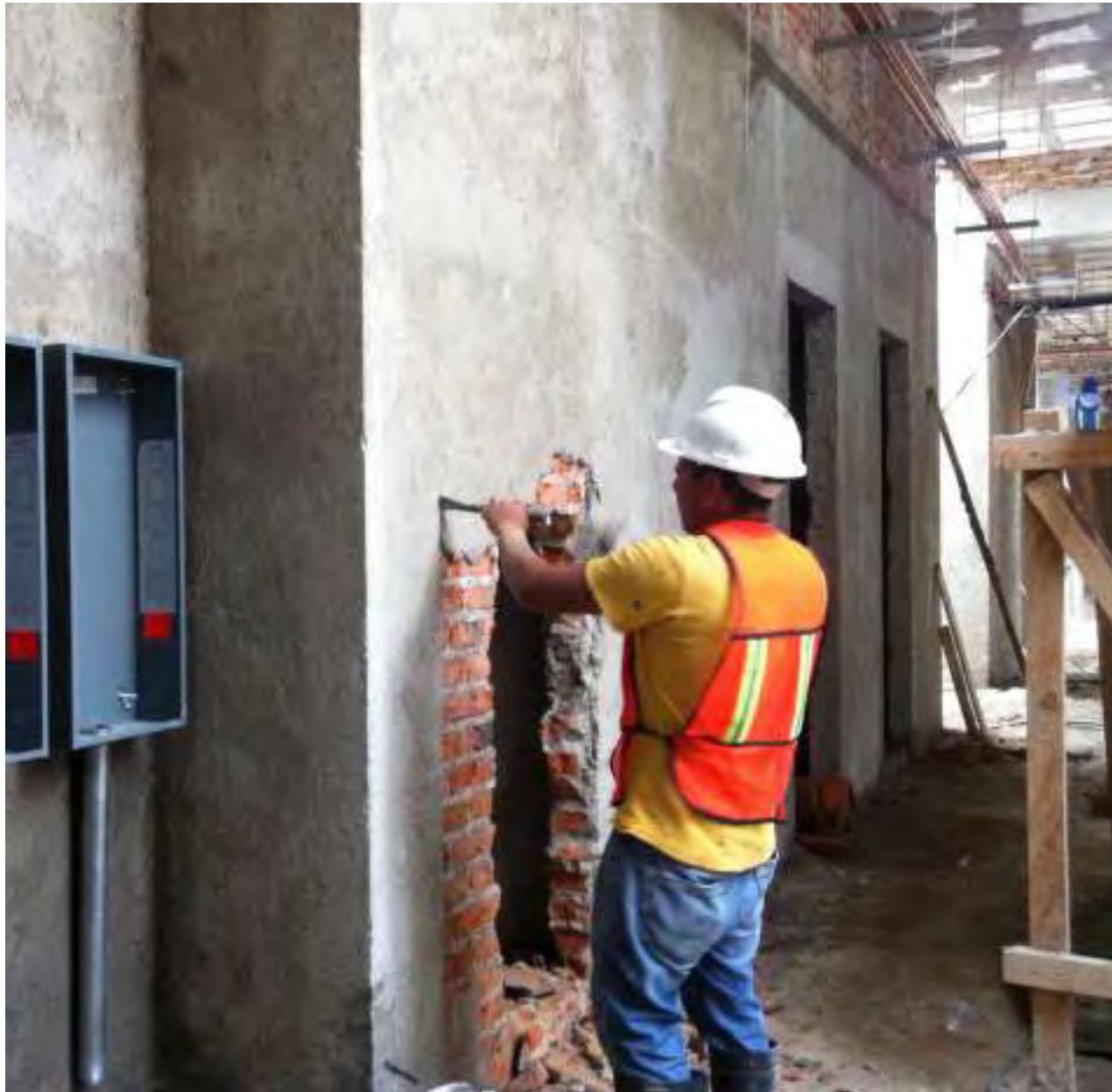
Fotografía del personal de obra abriendo los recorridos de instalación eléctrica dentro de los muros de tabique de barro rojo recocido para la instalación de contactos y apagadores.
