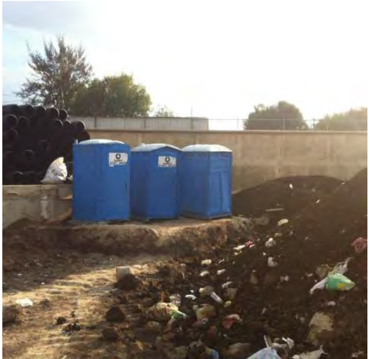
Fotografía de la instalación provisional de sanitarios para el personal de obra de marca SaniRent. Estos elementos se iban moviendo zona por zona de acuerdo a los trabajos que se iban completando en todo el conjunto de la obra.
