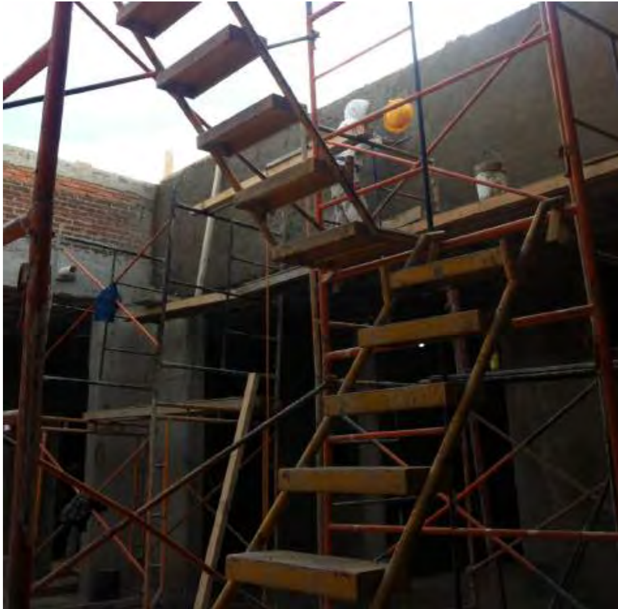
Fotografía de la escalera provisional que se utilizó en el patio del edificio A para el aplanado de pretiles de barro rojo recocido y para facilitar el acceso a las azoteas.
