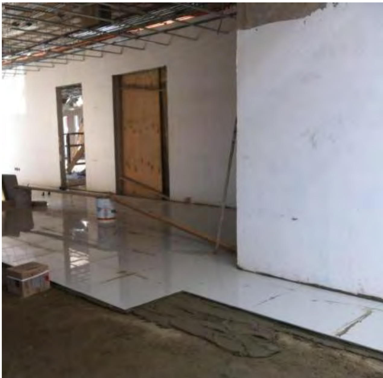
Fotografía del proceso de colocación de loseta cerámica en los pasillos del edificio D asentado con adhesivo marca Interceramic y con juntas de 2mm entre una loseta y otra.
