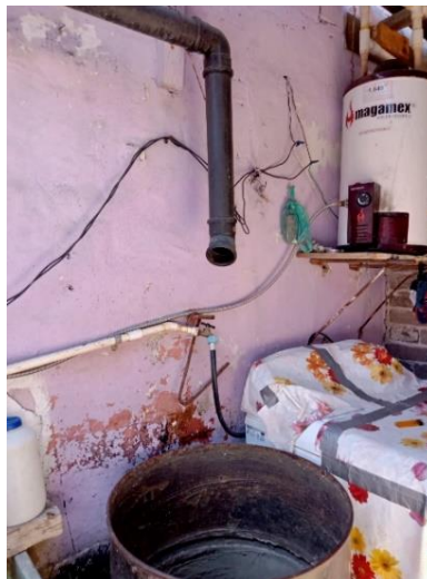
Imagen 29. Sistema de Captación de Agua de Lluvia desmantelado
