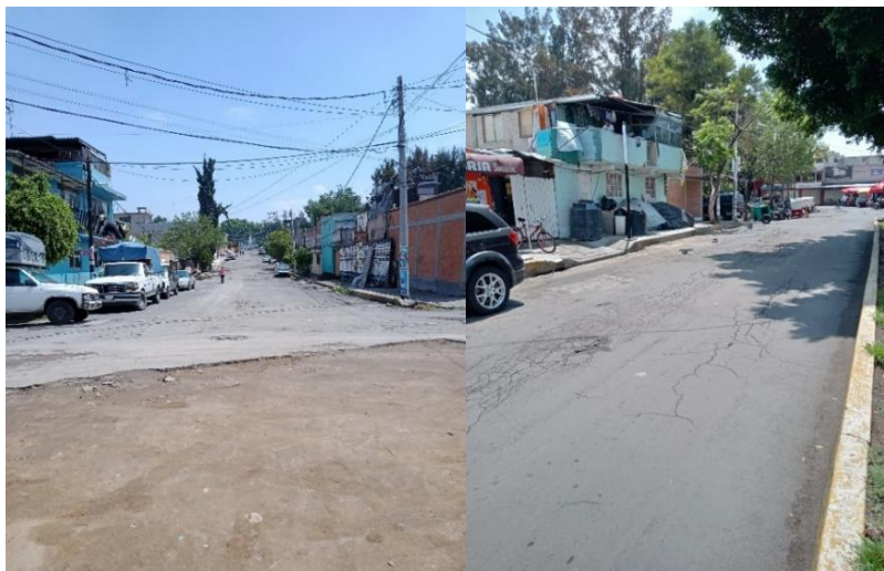
Imagen 21. Calles sin pavimentar y con grietas
