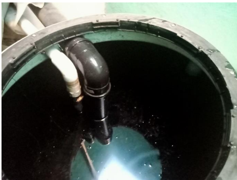
Imagen 34. Tanque de almacenamiento sin cloro en Desarrollo Urbano Quetzalcóatl
