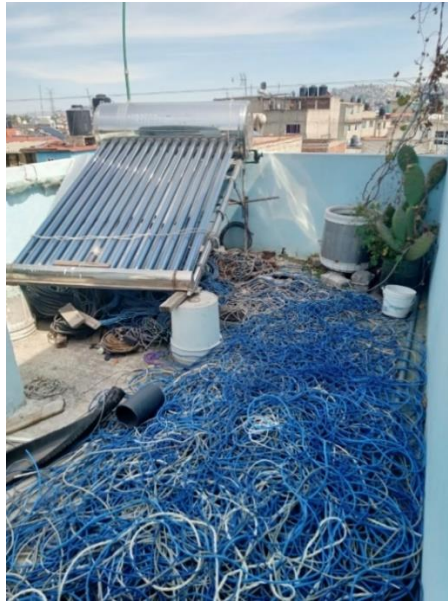
Imagen 30. Techo con cables en Desarrollo Urbano Quetzalcóatl
