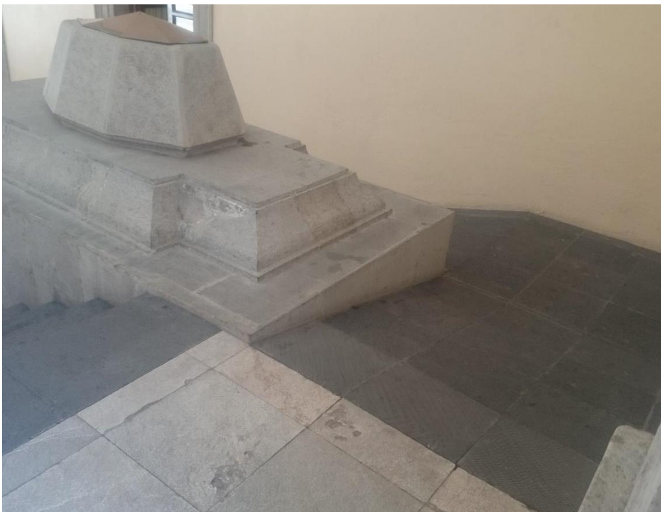
Fotografía 16. La estructura para sostenerse es inadecuada tanto en la rampa como en la escalera.
