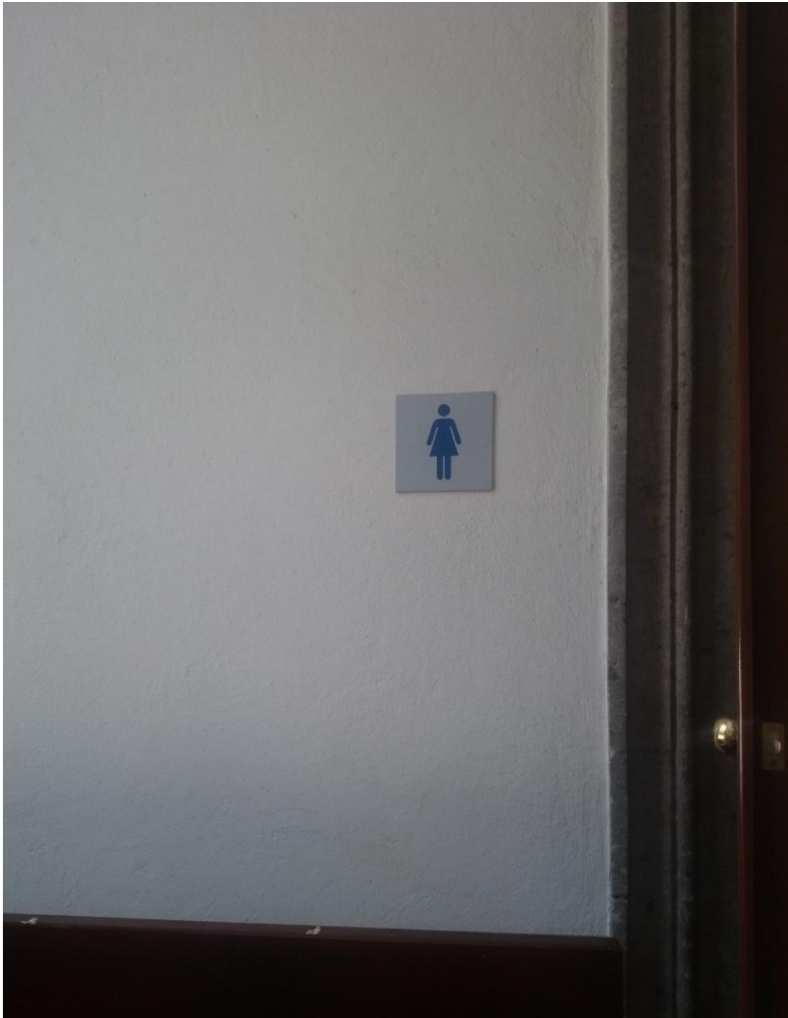
Fotografía 6. En uno de los baños de mujeres se muestra que la puerta no es adecuada para su uso a personas con sillas de ruedas.
