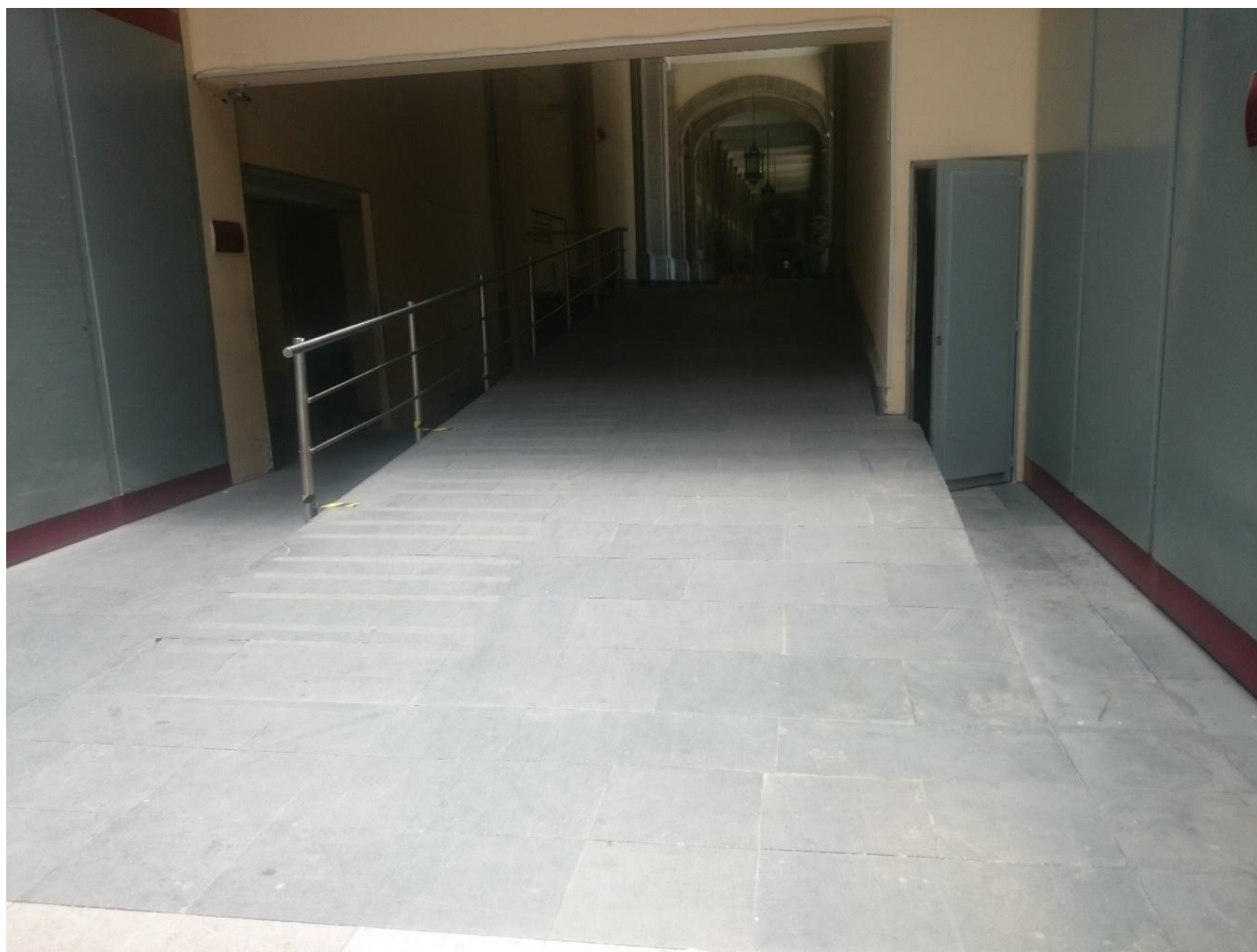
Fotografía 22. Se muestra una rampa fija con un barandal adecuado para su uso.
