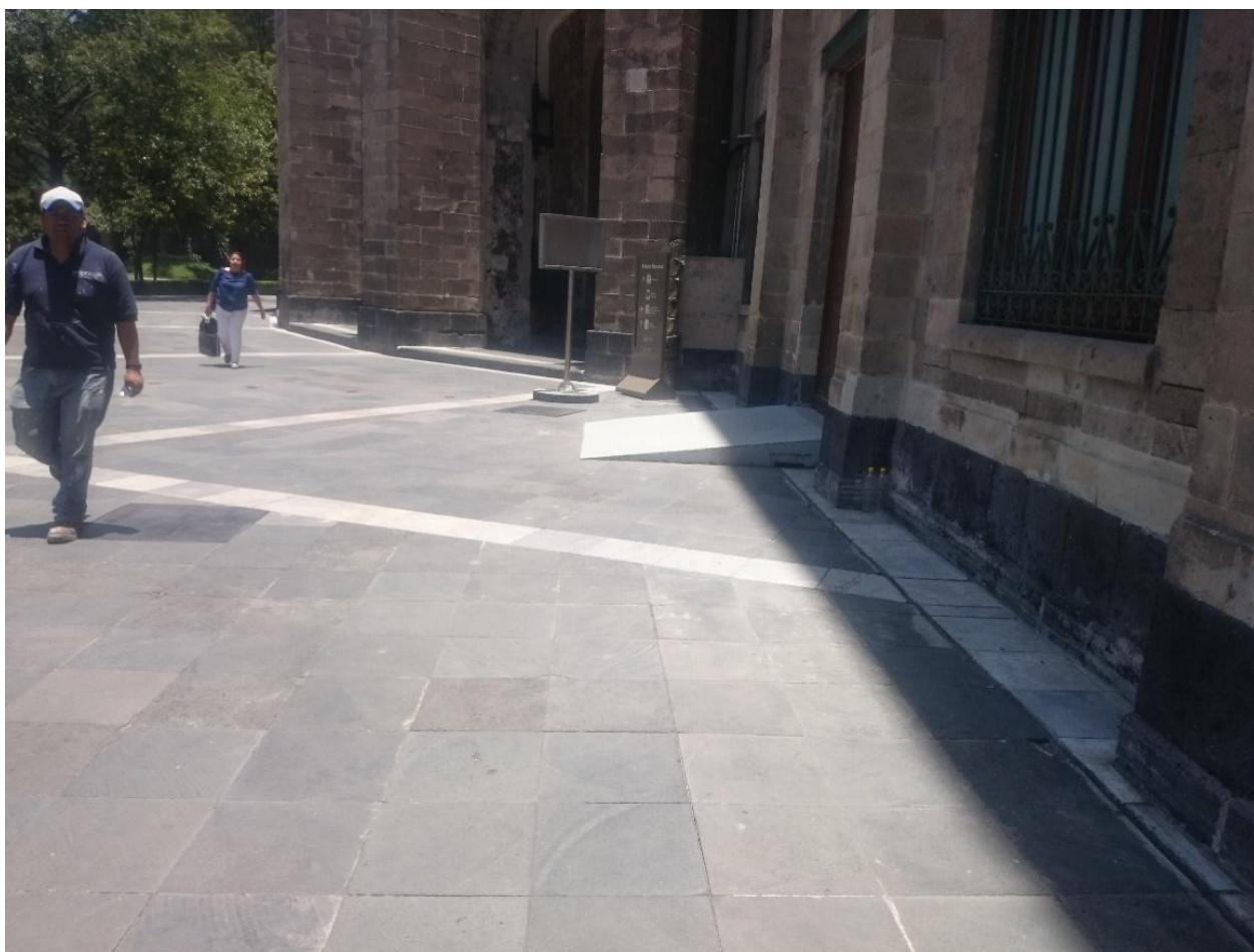
Fotografía 2. En ese mismo pasillo se muestra que a pesar de contar con esa rampa existen coladeras con tapas de metal semifijas que representan un factor de riesgo para un accidente.
