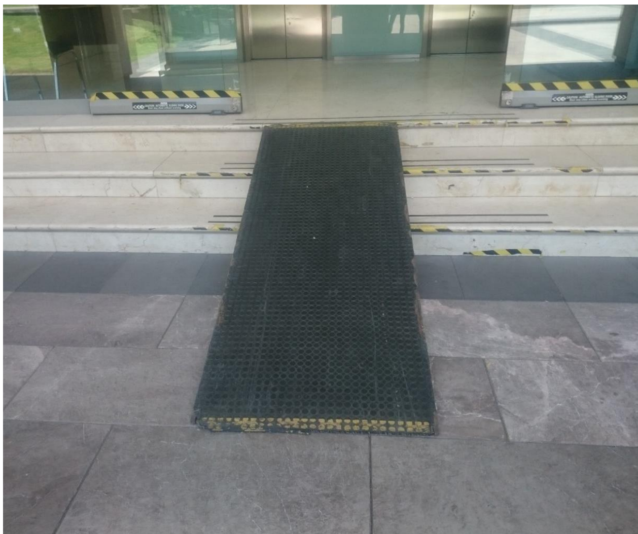
Fotografía 19. Teniendo aun en algunos edificios rampas semifijas estas no son seguras.
