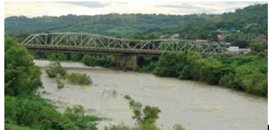
IMAGEN 13. Puente cazonos, foto tomada en sitio.
