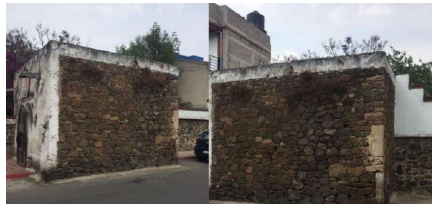
Figura 81. Fotografía propia. Vista lateral del inmueble. Es posible ver su deterioro, y su estado actual, 2022.
