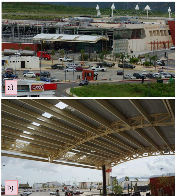
Figura 2.7 Cubierta adyacente a la terminal 1 (Murià Vila et al., 2015): a) vista en perspectiva; b) zona de daño de la cubierta
