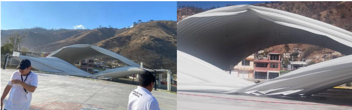
Figura 2.10 Unidad Deportiva de Motozintla colapsada (Araujo, 2023; García, 2023)
