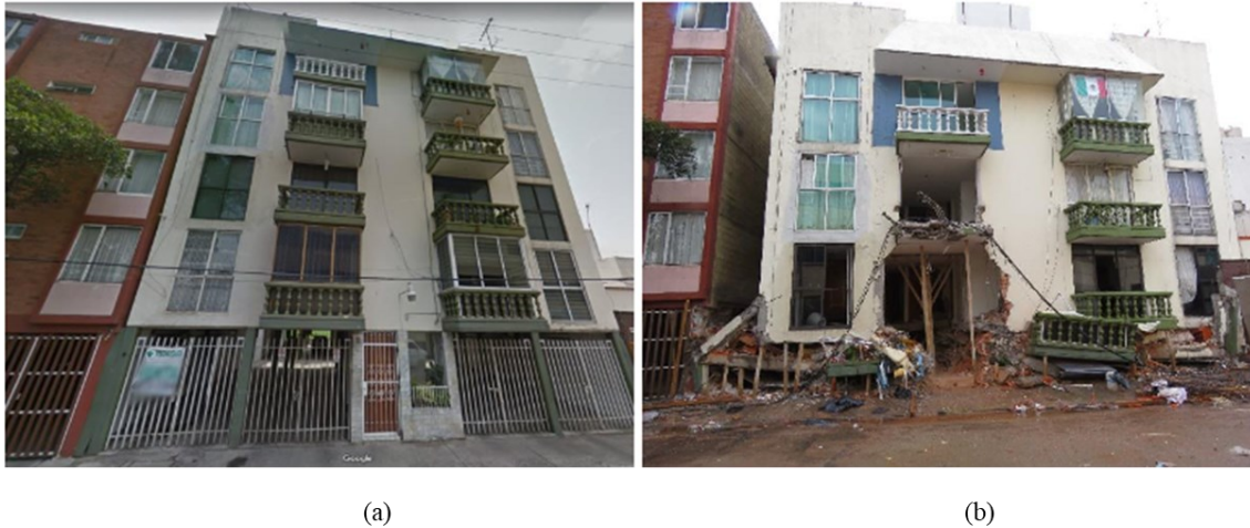
Figura 1.3. Estructura con planta baja débil (a) antes del sismo del 19/09/2017 y (b) después del sismo del 19/09/2017 (Galvis et al., 2017)
