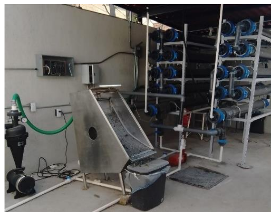
Figura 18. Sistema de tratamiento de aguas residuales a pequeña escala en San Lorenzo Xochimilco.
