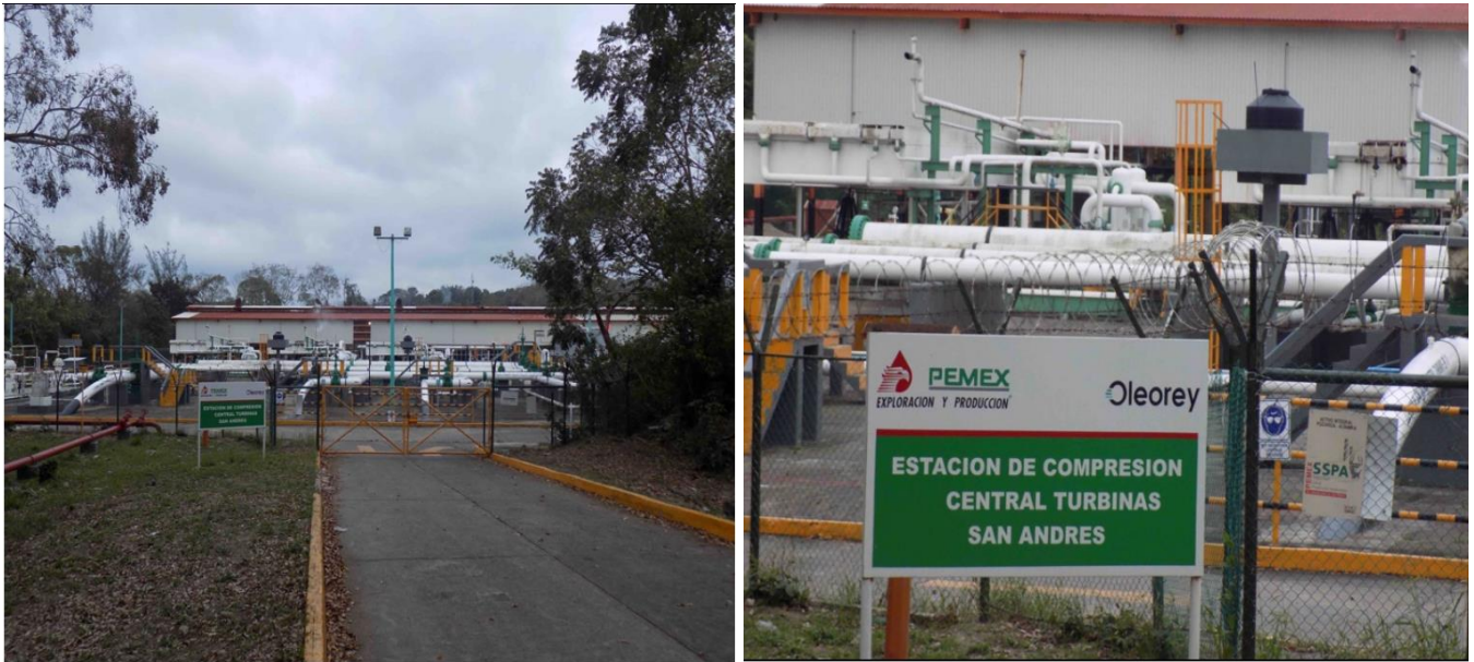
Figura 2.22. Toma 1 y 2 de la central de turbinas ubicada en la comunidad de Emiliano Zapata, Papantla. Fuente: Aguilar, 2017.
