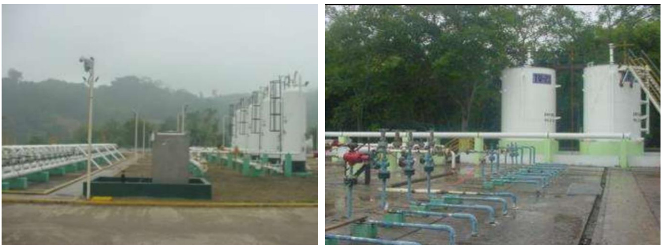
Figura 2.24. Batería de separación San Andrés III (Izquierda). Planta de inyección de agua congénita (derecha). Fuente: PEMEX Exploración y Producción, 2012c.
