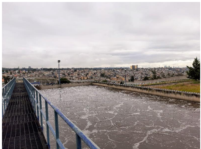
Figura 3.12. Reactor aireado, PTAR Santa Fe
