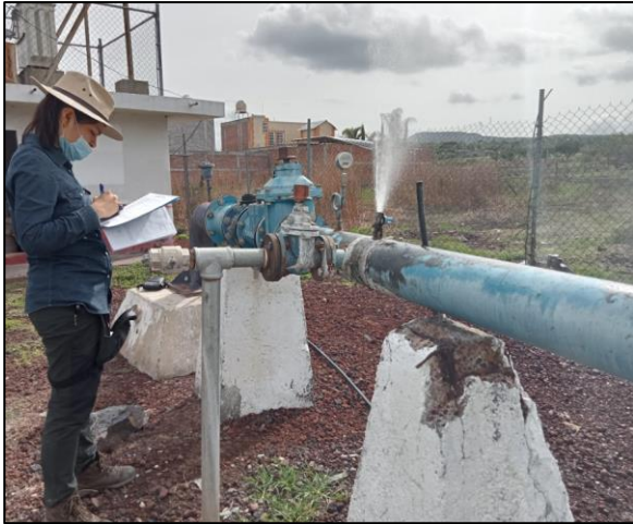
Fig. 33: Flujo en llave de control de pozos hídricos de 3 a 5 min, para evitar condición de estancamiento.
