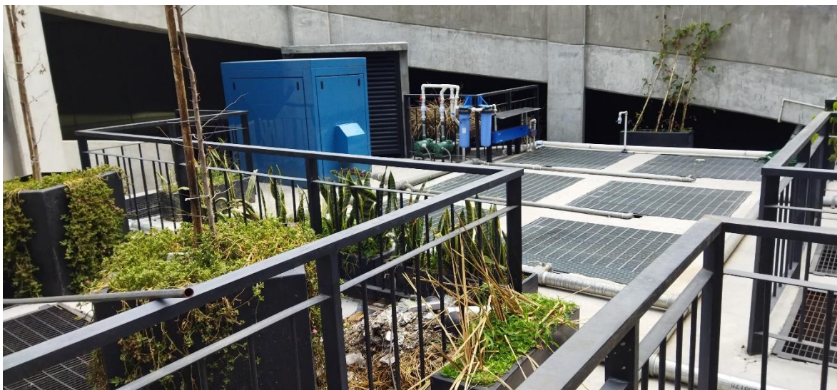
Fotografía 17: Parte superior de la planta de tratamiento de agua, construida en el espacio residual de las rampas del estacionamiento.
