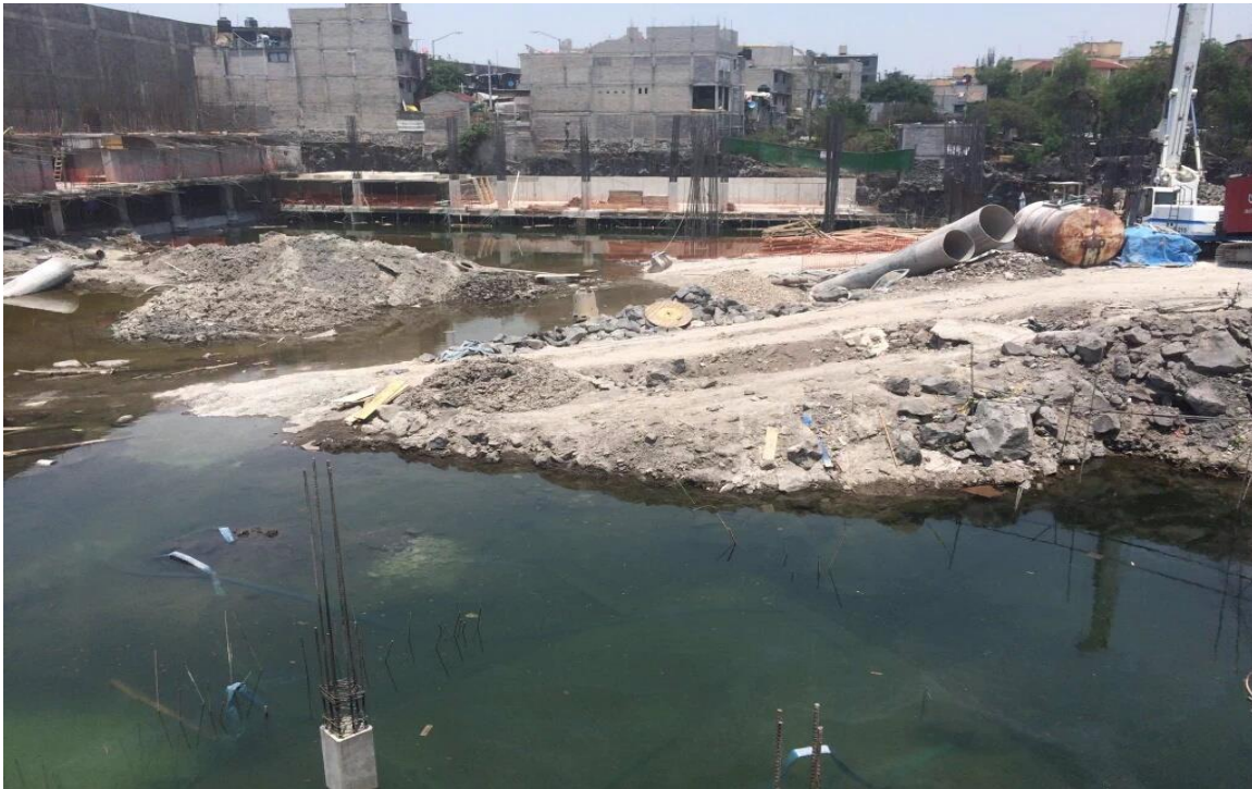
Fotografía 11: Predio de Aztecas 215 inundado durante los trabajos de excavación en 2016. Fuente: Imagen obtenida del documento: “Cronología” Elaborada por la Asamblea General de Pueblos, Barrios, Colonias y Pedregales de Coyoacán, en línea.
