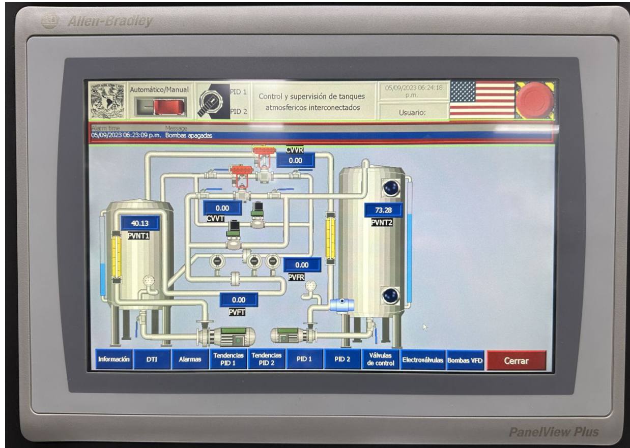
Figura 4.4 HMI cargada en PanelView Plus 7 Standard.
