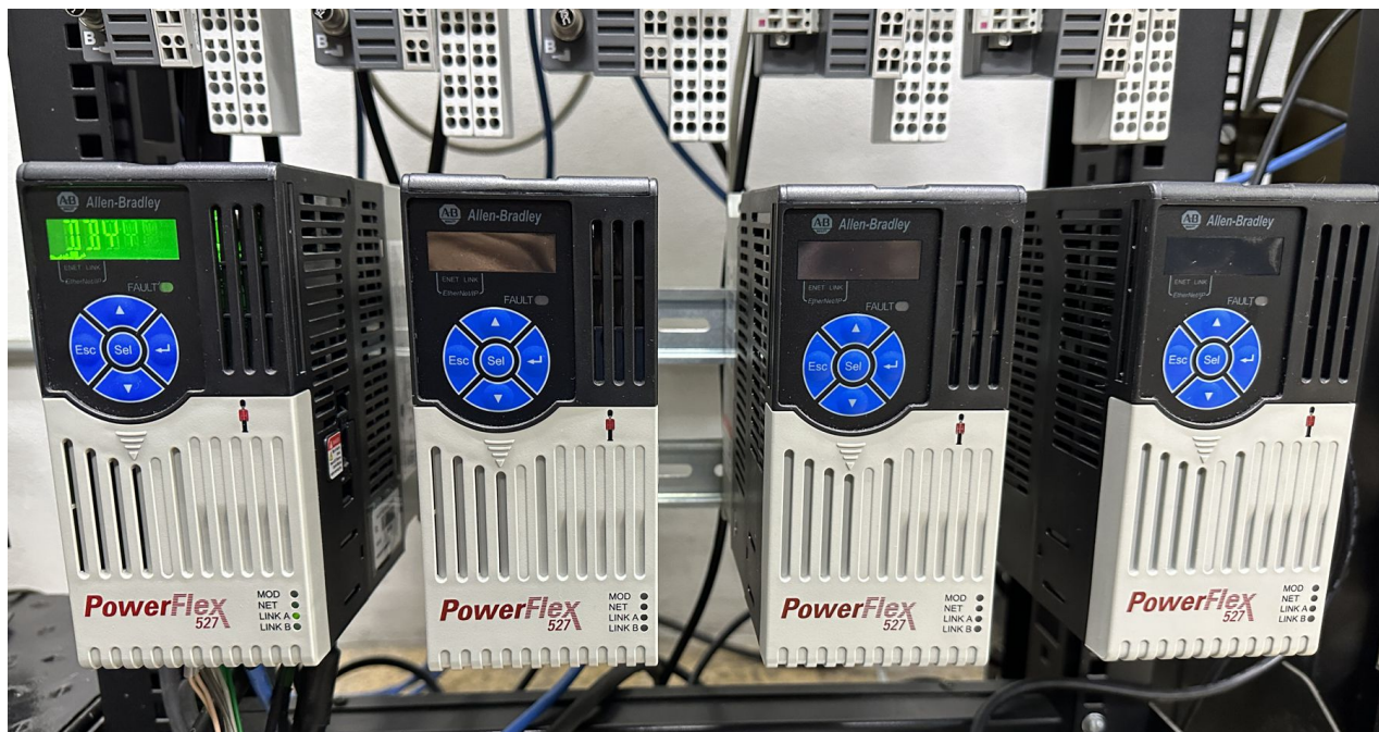
Figura 4.3 Variadores de frecuencia PowerFlex 527.
