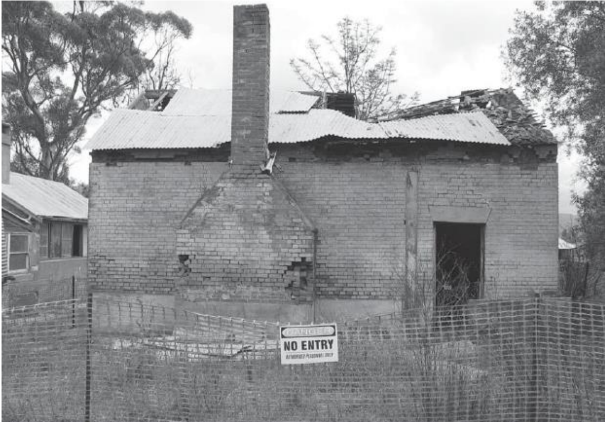
Figura 3.8 Afectación en una estructura histórica (Jordan, Sutcliffe, & Mullard, 2009)
