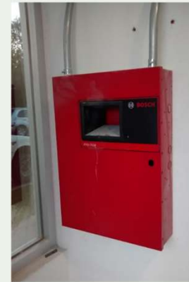
Panel de incendio
