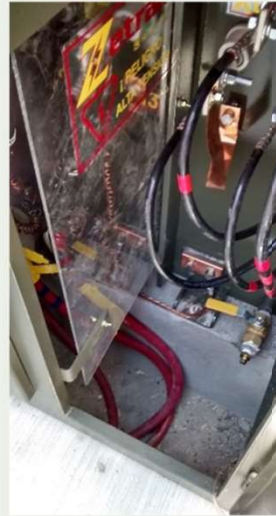
Acometida a Transformador.
