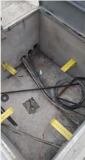
Registro para acometida eléctrica en media tensión.
