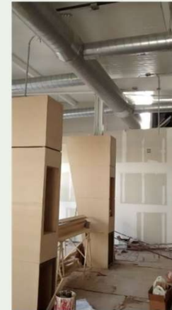
Ductos de aire acondicionado tipo Espiro ducto.
