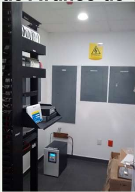
Cuarto de Comunicaciones (SITE)
