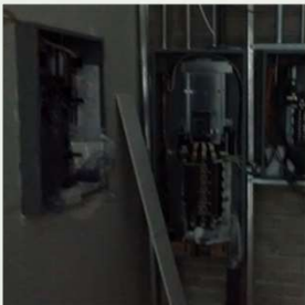
Peinado de tableros de SITE.
