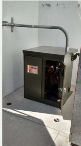
Transformador trifásico capacidad de 75 KW.
