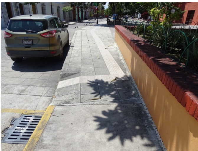
Se puede observar como el pavimento con guía táctil termina abruptamente en la zona de transición. Fuente: elaboración propia, 2022
