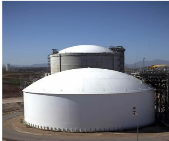
Figura 38. Tanque de almacenamiento de doble pared (Quintero, 2022).
