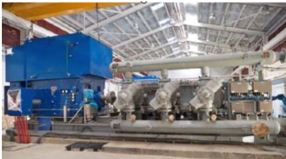
Figura 83. Compresor eléctrico utilizado en Yela (Enagas, 2020).
