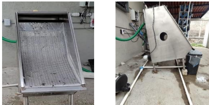
Figura 11 Derrame de agua residual pretratada proveniente de la criba (izquierda) sistema de recolección de agua (derecha).
