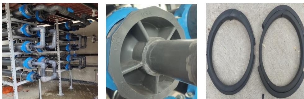
Figura 12 Fugas en el RBT, tubería adherida con pegamento para PVC y cambio de los empaques (antes y después).
