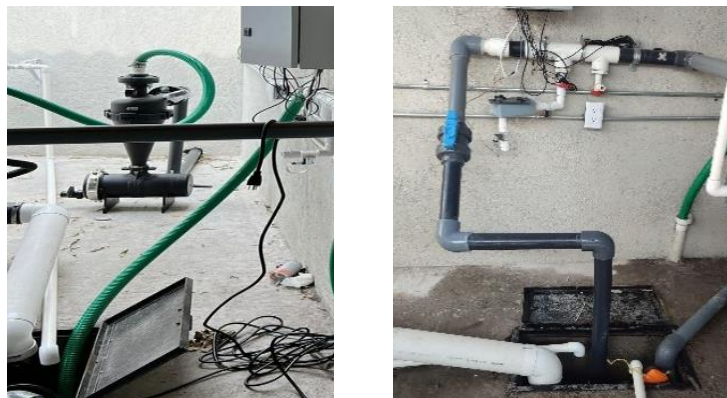
Figura 14 Primera configuración para la alimentación del reactor (izquierda) y modificación final (derecha).
