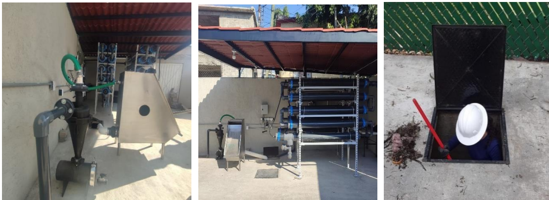
Figura 10 Equipos instalados en la PTAR San Lorenzo Xochimilco y acondicionamiento de la planta.
