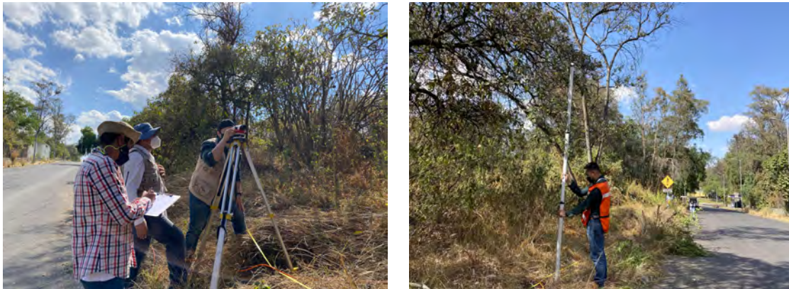
Figura 5.11: Memoria fotográfica de la toma de nivelación realizada en la línea 1 de REPSA A8, posteriormente se realizó la toma en las líneas de tendido 2 y 3, así como, sus correspondientes separaciones electrónicas reales.
