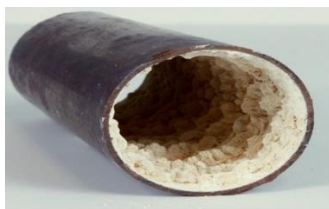
Fig. (37). Incrustaciones en tuberías. (purewater, 2023)
