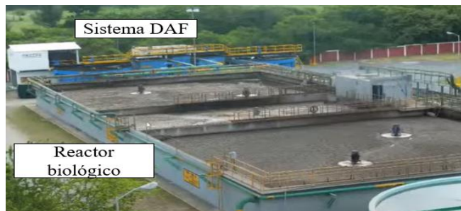
Fig. (61). Reactor biológico, planta de tratamiento de aguas residuales de la refinería Madero (Cisneros, 2022).
