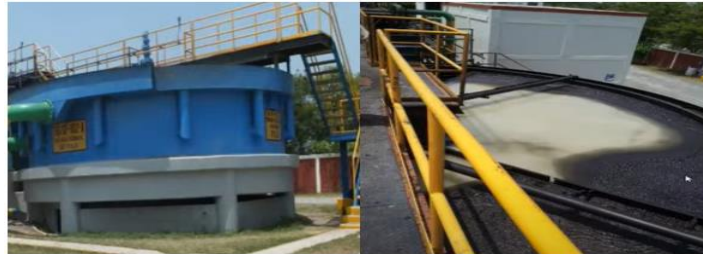
Fig. (60). Sistema DAF, planta de tratamiento de aguas residuales de la refinería Madero (Cisneros, 2022).
