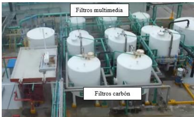
Fig. (63). etapa de filtración, planta de tratamiento de aguas residuales de la refinería Madero (Cisneros, 2022)
