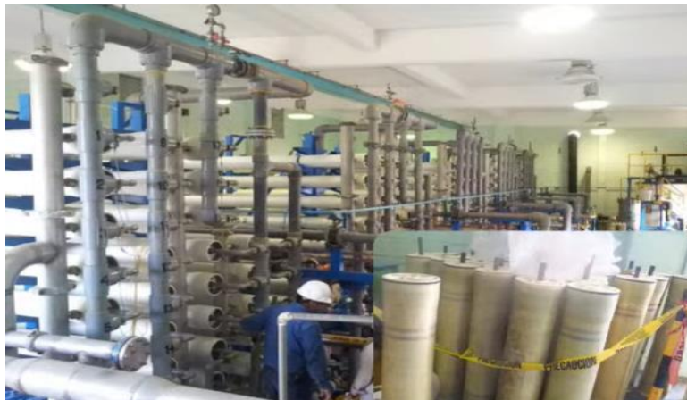
Fig. (64). Etapa de ósmosis inversa, planta de tratamiento de aguas residuales de la refinería Madero (Cisneros, 2022).
