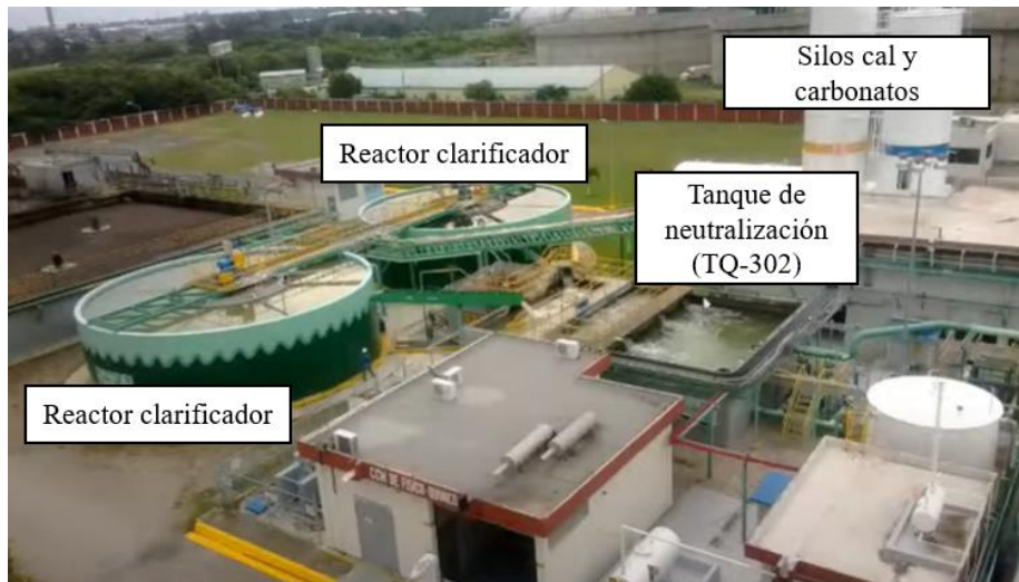
Fig. (62). reactores clarificadores y tanque de neutralización, planta de tratamiento de aguas residuales de la refinería Madero (Cisneros, 2022).
