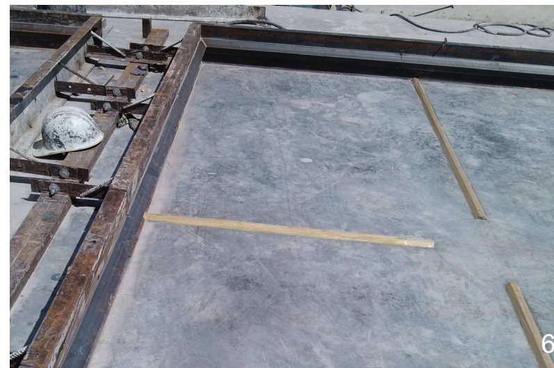
Fotos 4, 5 y 6: muestran proceso de elaboración de moldes metálicos para prefabricados. Estos trabajos se realizaron en paralelo a los trabajos preliminares en sitio para eficientar tiempos.
