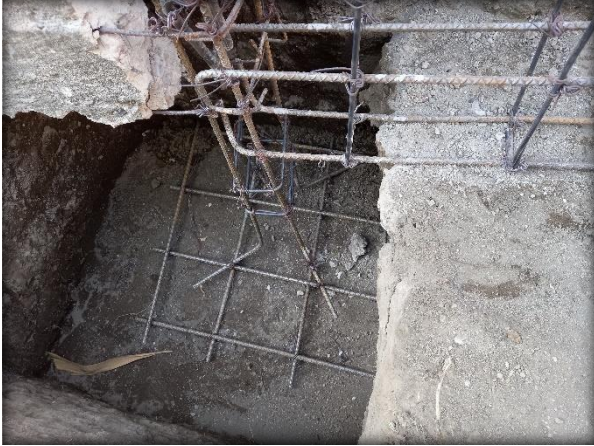
Fig. 141. Armado de zapata en vivienda con falta de cimentación. Elaboración Propia.
