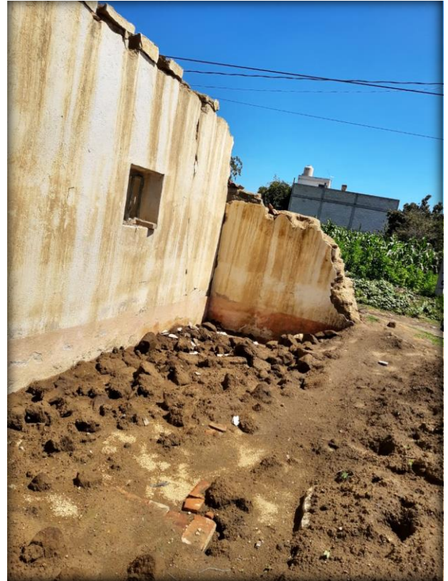
Fig. 62. Colapso total de estructura, ejemplo 6. Elaboración Propia.
