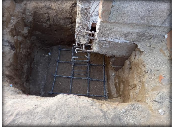
Fig. 142. Armado de zapata en vivienda con falta de cimentación. Elaboración Propia.
