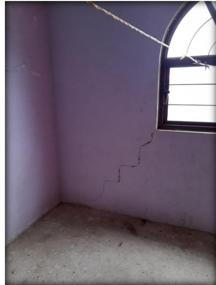
Fig. 54. Fractura en ventana, ejemplo 2. Elaboración propia.
