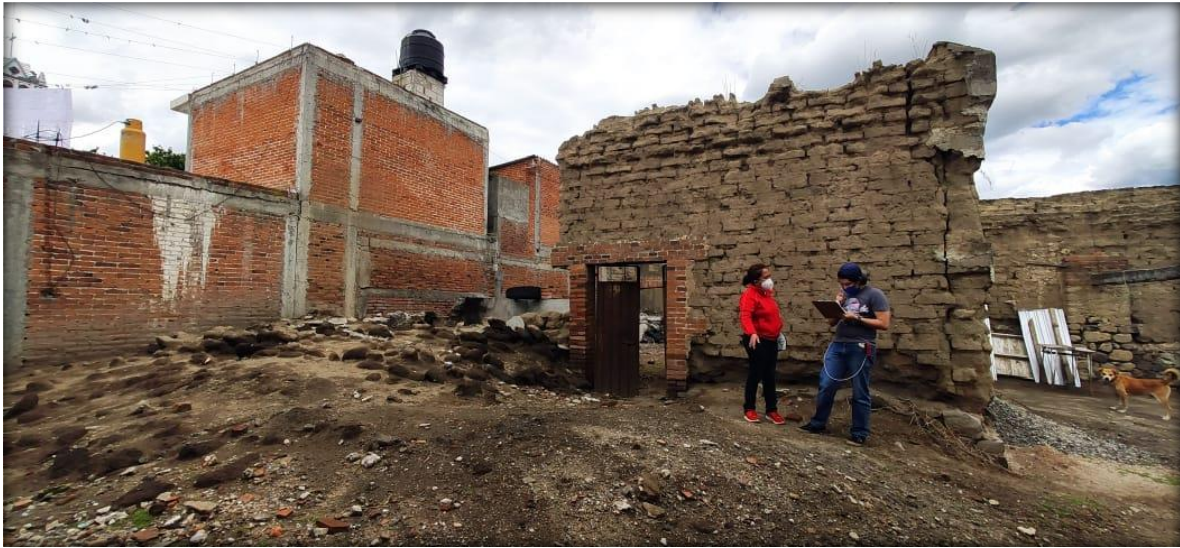
Fig. 57. Colapso total de estructura, ejemplo 1. Elaboración Propia.
