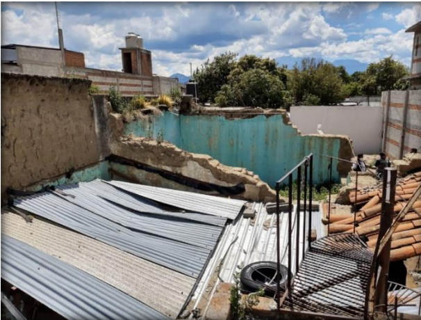
Fig. 60. Colapso total de estructura, ejemplo 4. Elaboración Propia.
