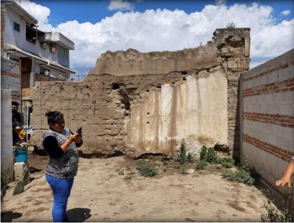
Fig. 59. Colapso total de estructura, ejemplo 3. Elaboración Propia.
