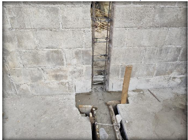
Fig. 144. Zapata en vivienda con falta de cimentación. Elaboración Propia.
