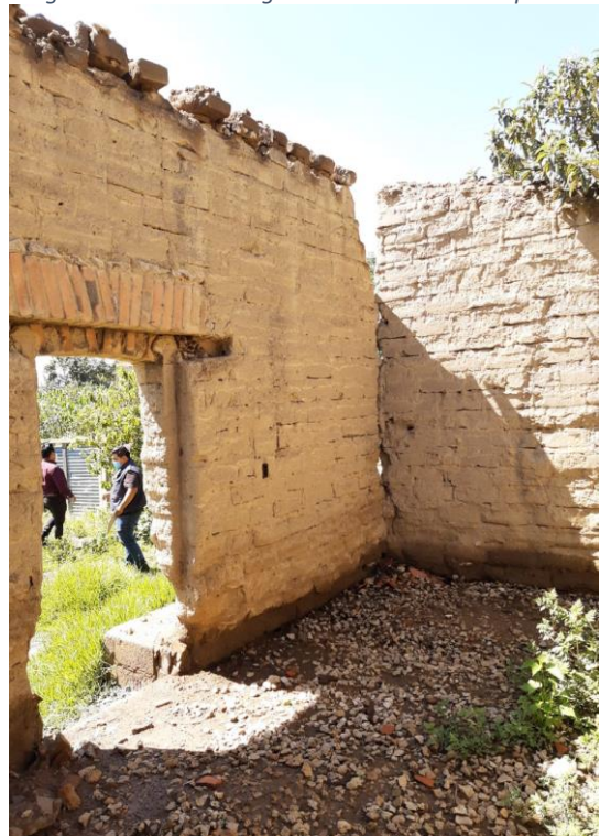
Fig. 50. Colapso de cubierta, ejemplo 2. Elaboración Propia.
