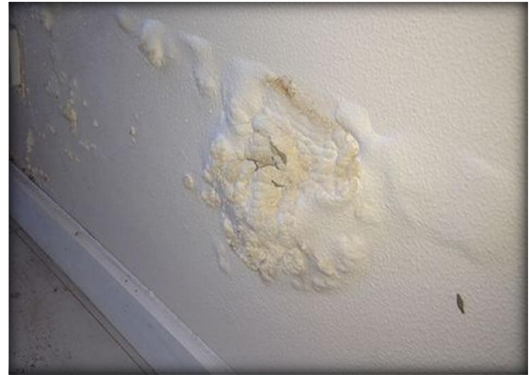
Fig. 3. Humedad en muros de Vivienda. HUMEDADES. https://www.hogarseco.com/humedades-por-capilaridad/ (Madrid, España, 2023)
