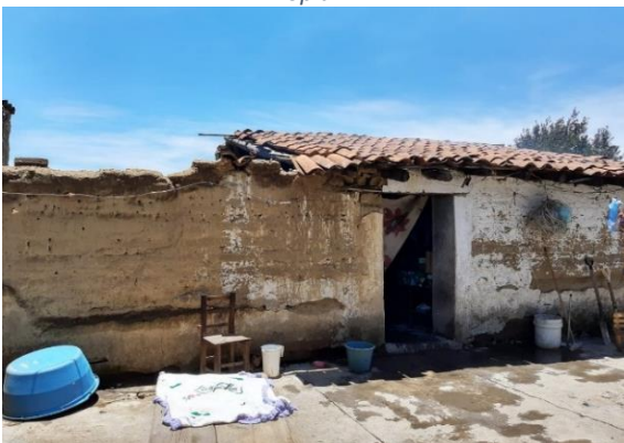
Fig. 51. Colapso de cubierta, ejemplo 3. Elaboración Propia.
