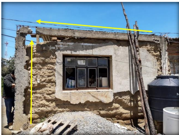
Fig. 40. Falla por errores constructivo, ejemplo 1. Elaboración Propia.
