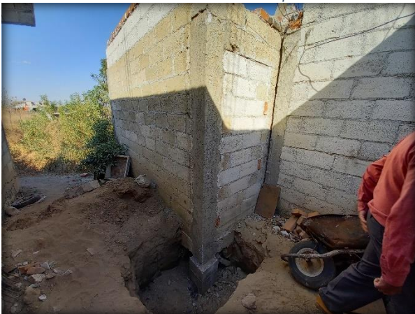
Fig. 143. Zapata en vivienda con falta de cimentación. Elaboración Propia.
