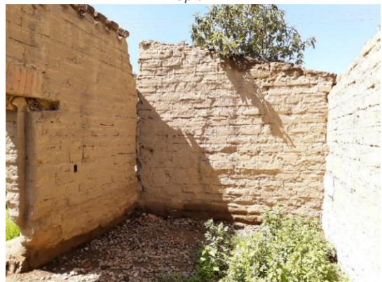
Fig. 52. Colapso de cubierta, ejemplo 4. Elaboración Propia.
