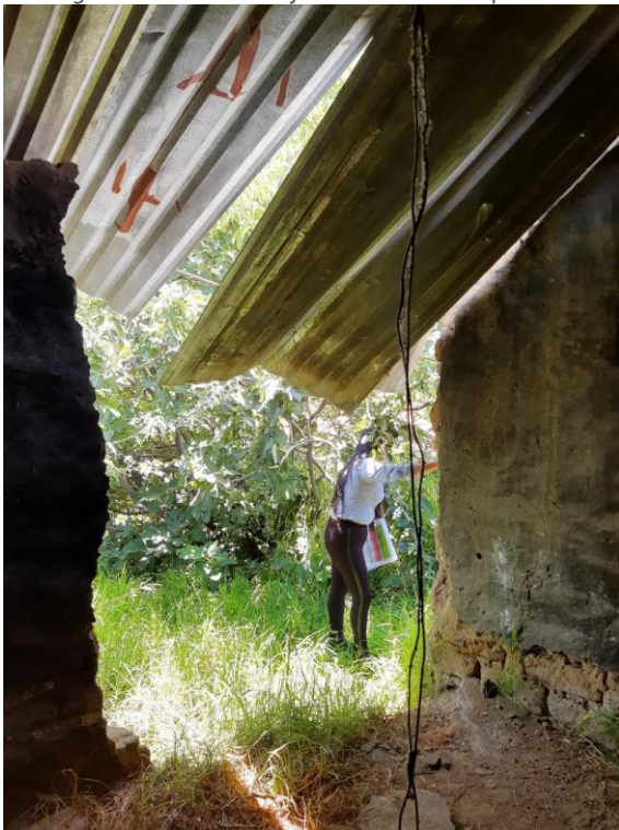
Fig. 49. Colapso de cubierta, ejemplo 1. Elaboración Propia.
