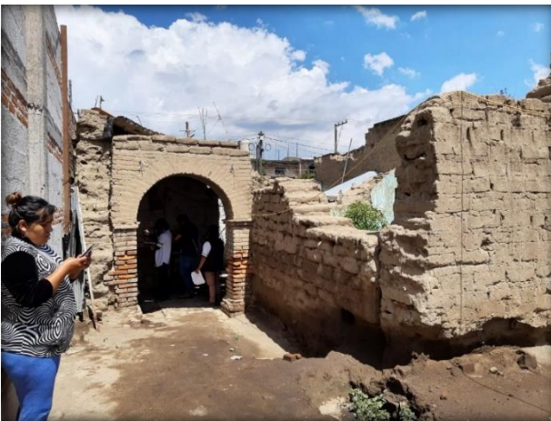
Fig. 61. Colapso total de estructura, ejemplo 5. Elaboración Propia.
