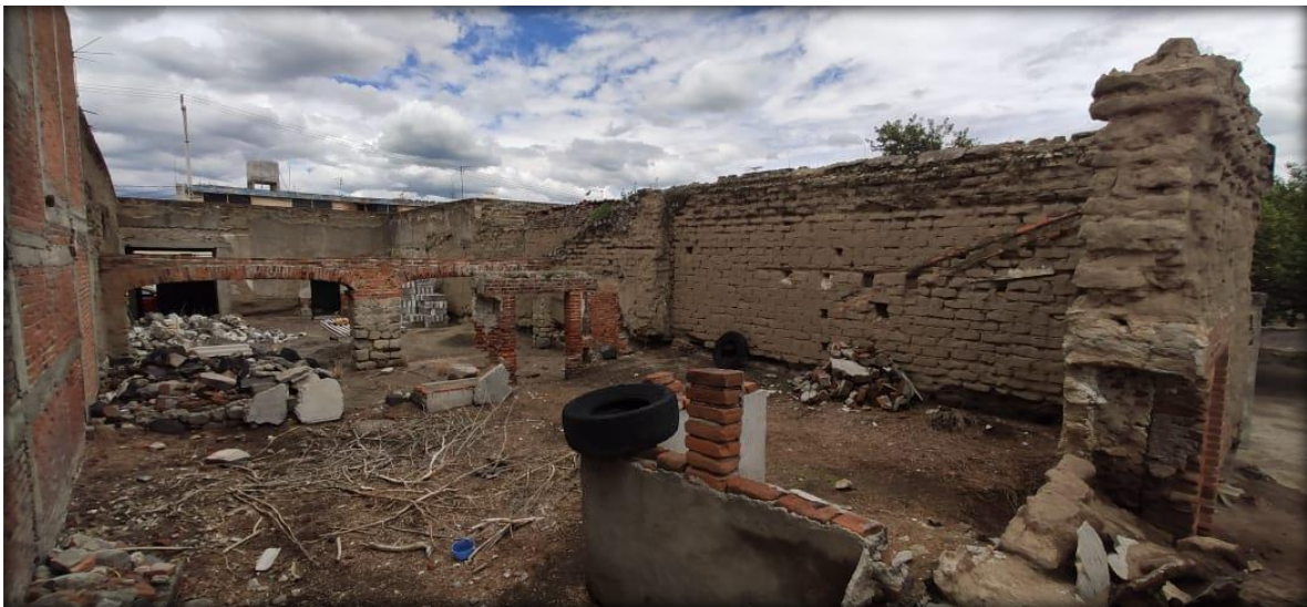
Fig. 58. Colapso total de estructura, ejemplo 2. Elaboración Propia.
