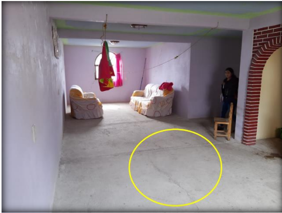
Fig. 43. Fractura en firme de concreto, ejemplo 2. Elaboración Propia.
