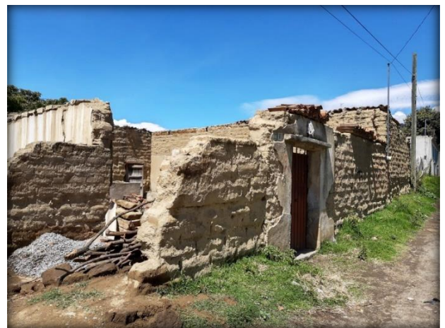
Fig. 63. Colapso total de estructura, ejemplo 7. Elaboración Propia.
