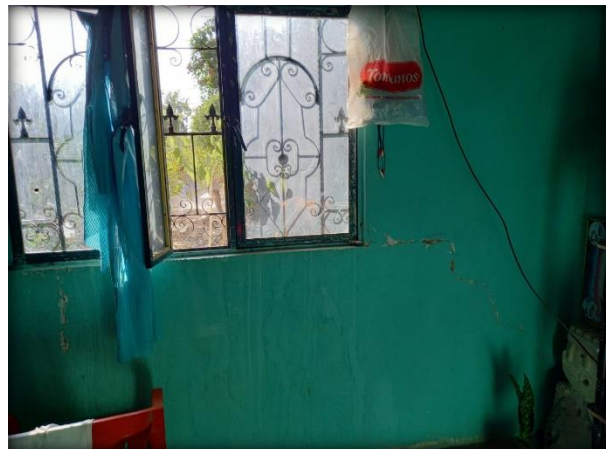
Fig. 56. Fractura en ventana, ejemplo 4. Elaboración propia.
