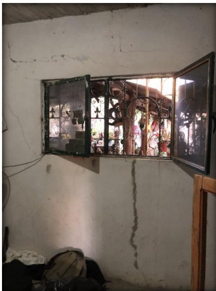
Fig. 55. Fractura en ventana, ejemplo 3. Elaboración propia.
