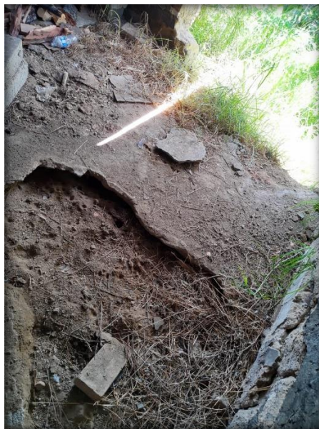
Fig. 42. Fractura en firme de concreto, ejemplo 1. Elaboración Propia.
