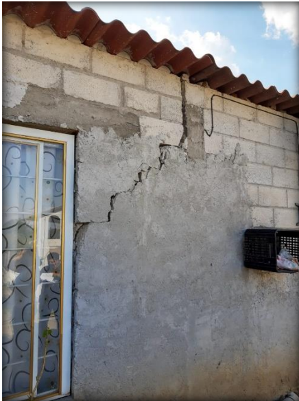
Fig. 53. Fractura en ventana, ejemplo 1. Elaboración propia.
