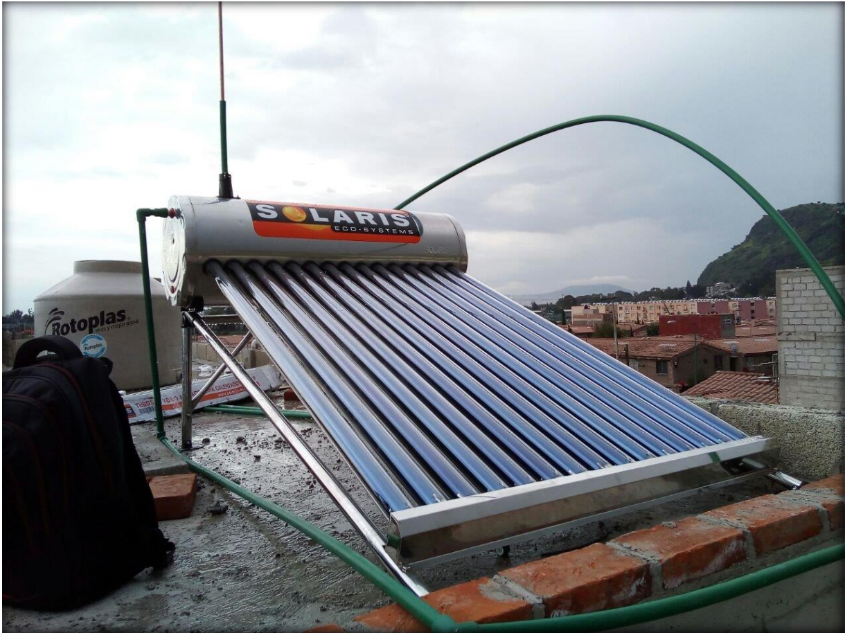
Fig. 169. Instalación Profesional de Calentador Solar. SOLARIS. https://solaresenmexico.com/producto/instalacion-profesional-para-calentador-solaris-cpvc/ (CDMX, 2023)
