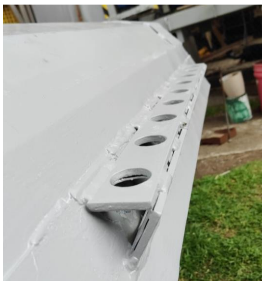
Imagen 68 Solución reforzamiento de sujetadores. Elaboración propia.
