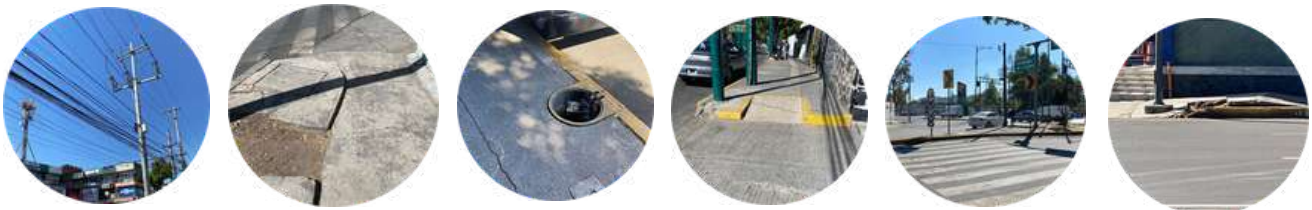
IMAGEN 51. Registro fotográfico de problemáticas. Fuente: Autoría propia.
