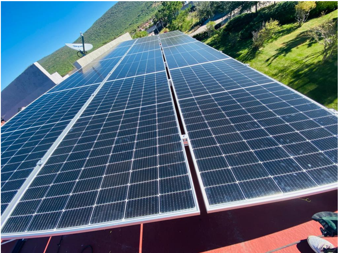
Figura 40: Sistema fotovoltaico “Querétaro”.
